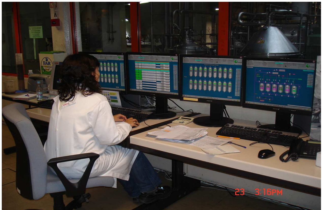
Figura 15 - Sala de controlo das adegas.
