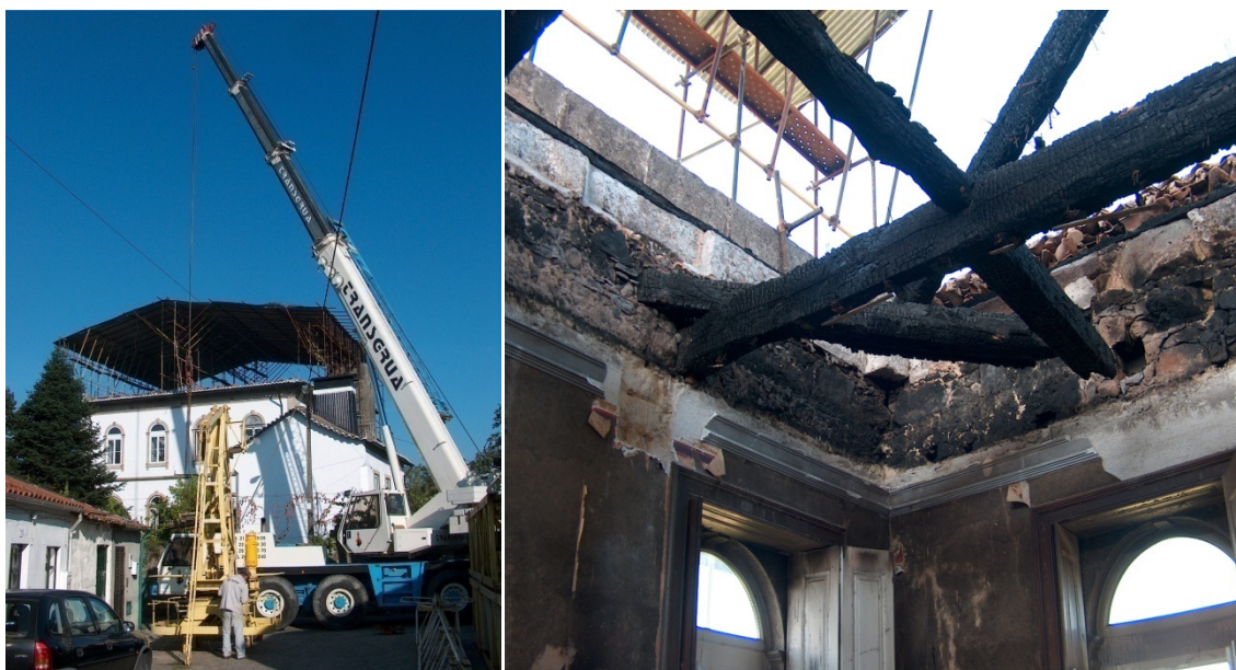
Fig.4.2 – Origem da madeira ardida. Esquerda: vista exterior sobre o palacete; Direita: Pormenor de um travamento realizado em madeira.
