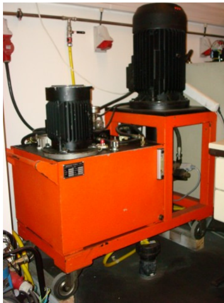
Figura 2:2 – Grupo Hidráulico do sistema
