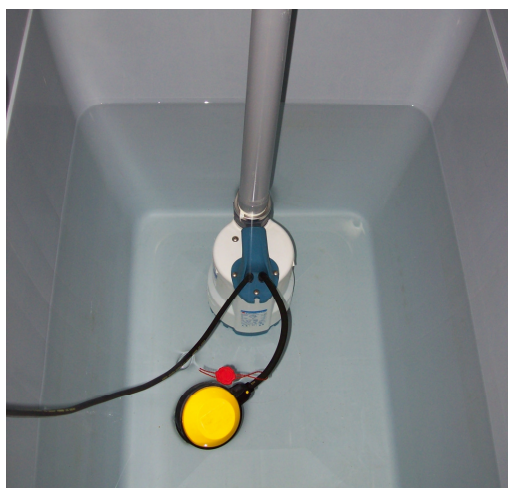
Figura 3.24 - Equipamento hidromecânico de bombagem.
