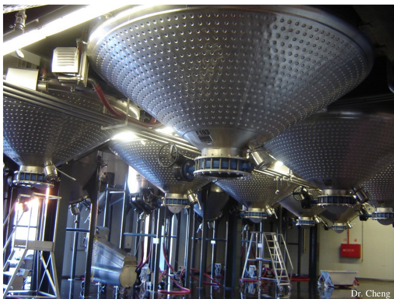
Figura 9 – Cubas de fermentação do vinho, fabricadas em inox com controle de temperatura.
