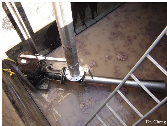
Figura 13 – Tanque de equalização da EPTAR da SOGRAPE VINHOS.
