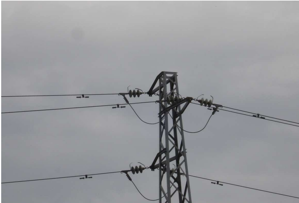
Figura 3.2 – Hastes de guarda com regulação deficiente.
