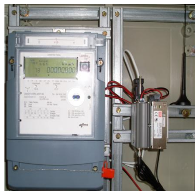
Figura 3.1.3 - Smart Meter em operação, via GSM
