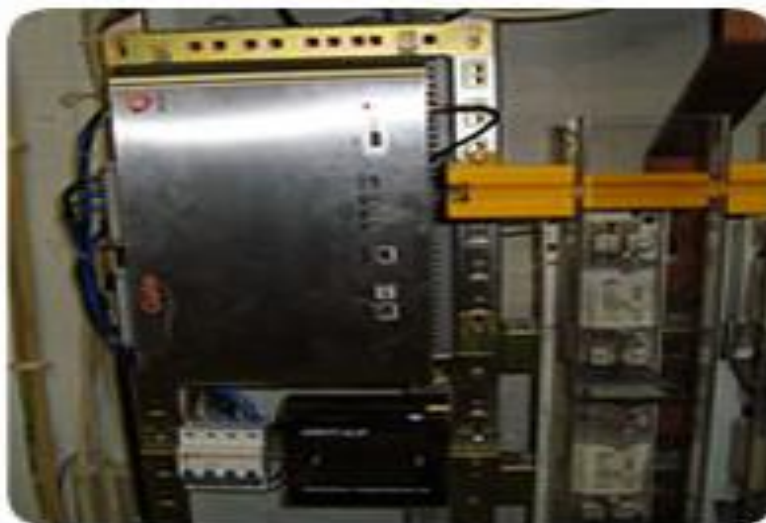
Figura 9.1.1.1.5 - Vista geral do DTC, no respectivo local do QGBT
