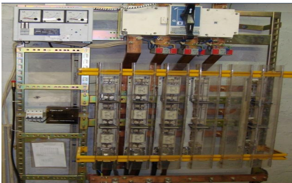
Figura 9.1.1.1.2 - Vista geral do QGBT, TIPO CA-2, preparado para receber o DTC
