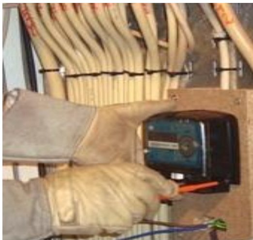
Figura 9.1.1.2.2 Instalação de uma Energy Box [ 37]
