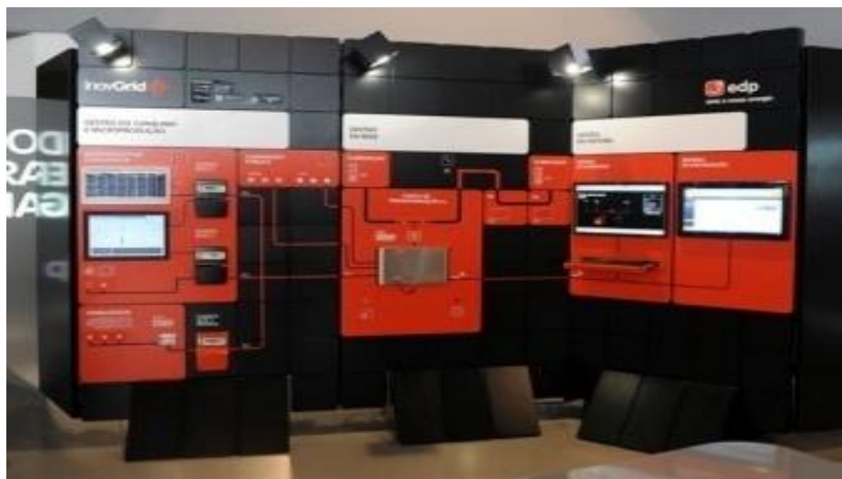
Figura 9.1.1.2.3 Painel Demonstrador do Projecto InovGrid [38]
