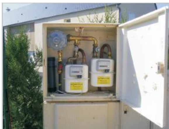
Figura 7.1.1 - Contador de gás em telecontagem [27]
