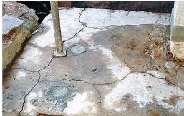
Figura 8. Deterioração provocada por reacções álcalis-silica (Fonte: Revista Techne)
