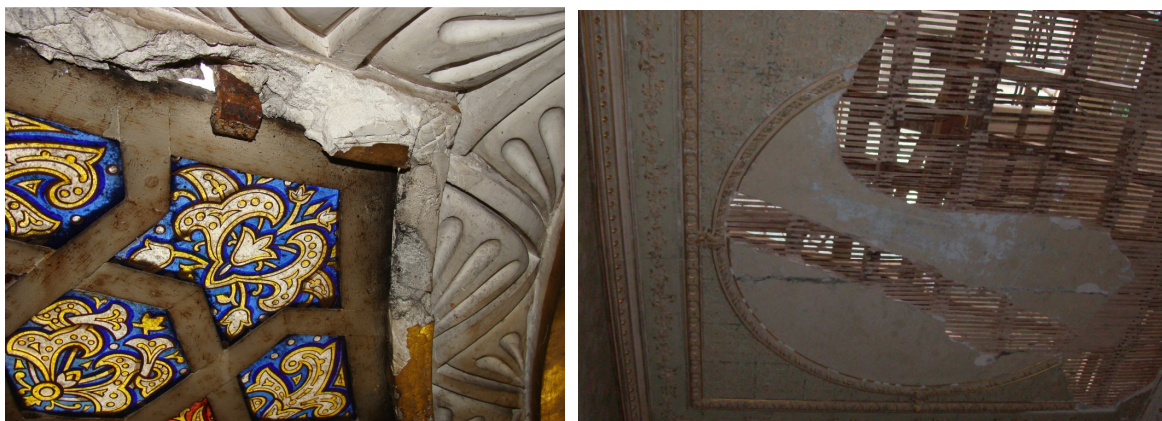
Fig. 4.3 – Lacuna em tecto, desprendimento de estuques (à esquerda) – Palácio da Bolsa do Porto, à direita, lacuna em tecto com perda total das diversas camadas do estuque – Cine-Teatro de Fafe.
