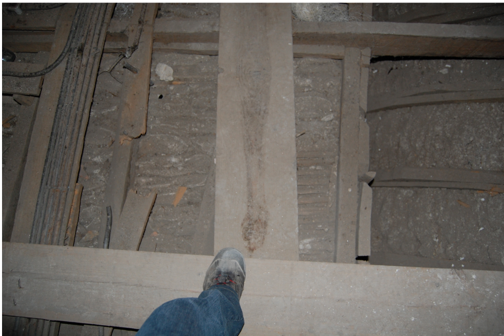
Fig. 6.22 – Sujidade no reverso do tecto
