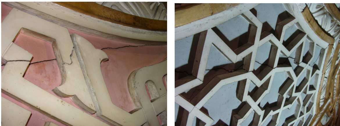
Fig. 4.9 – Fissuras em ornatos. Palácio do Marquês de Tomar, Lisboa. (à esquerda), à direita, fissuras em ornatos. Palácio do Marquês de Tomar, Lisboa.
