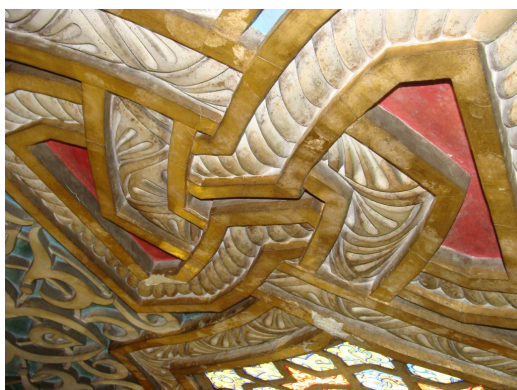
Fig. 4.8 – Manchas de sujidade. Palácio da Bolsa do Porto
