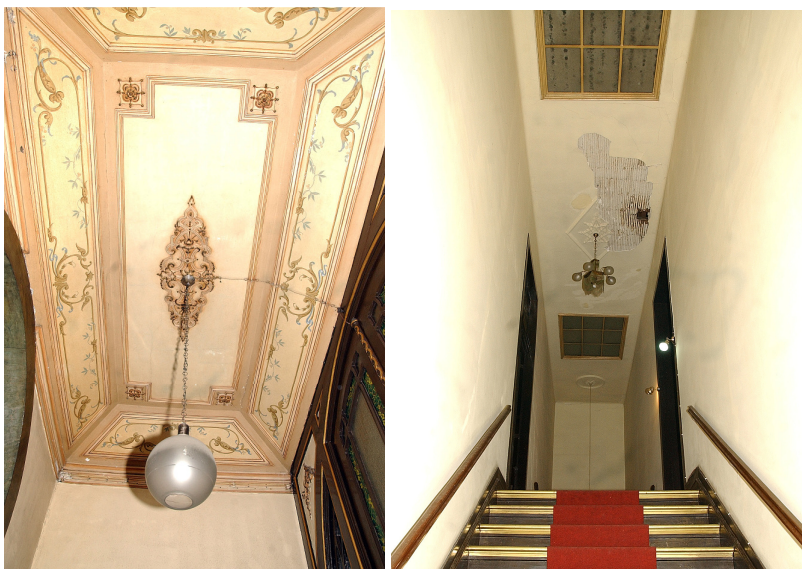
Fig. 6.10 – Tecto em estuque ornamental do hall de entrada (à esquerda) e à direita o tecto do hall, no qual se verifica o mau estado de conservação
