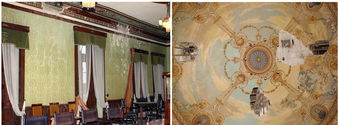
Fig. 6.18 – Exemplos de anomalias, devido à presença de água
