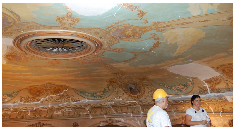
Fig. 6.30 – Aspecto das fissuras já tratadas na cúpula
