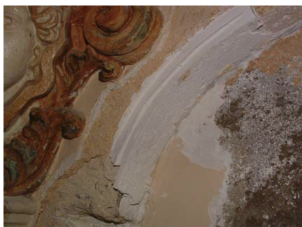
Fig. 4.6 – Perda de coesão do estuque, devido à presença de sais. Câmara Municipal de Setúbal
