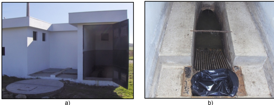
Figura 5.3 – Sistema de retenção de sólidos e gorduras (fonte: AdML): a) traseiras do edifício de apoio, com porta da obra de entrada aberta b) grades e cesto para recolher as lamas, quando se limpam os dispositivos
