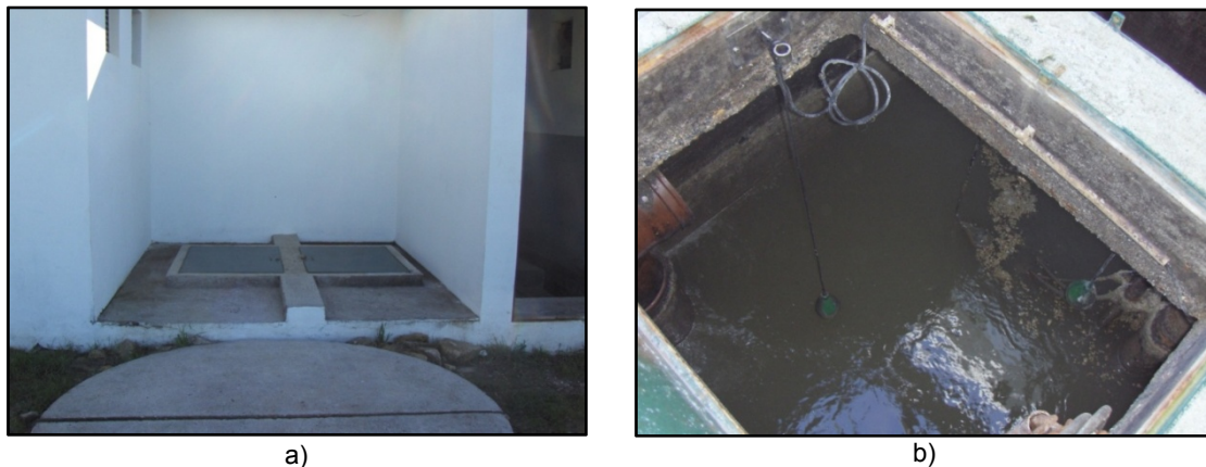
Figura 5.8 – Câmara de Aspiração (fonte: AdML): a) câmara fechada; b) câmara aberta (são bem visíveis duas bóias de nível)
