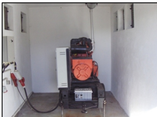
Figura 5.7 – Gerador de Emergência (fonte: AdML)
