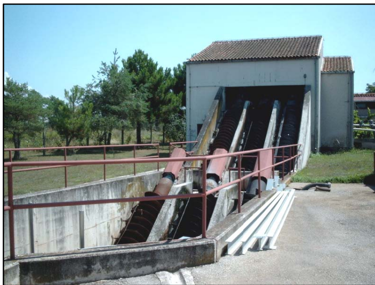
Figura 2.8 – Estação Elevatória com Parafusos de Arquimedes (Archimedes Screw - Wikipedia, 2007)
