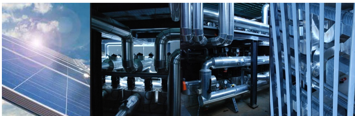
Figura 1.2 – Exemplos de instalações mecânicas resultado de projectos da AFAconsult
