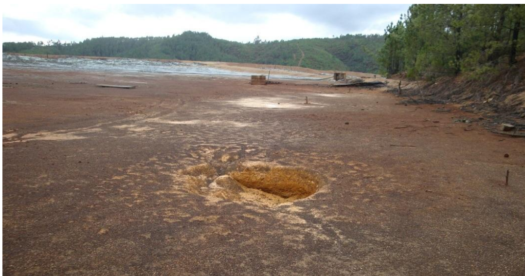
Figura 77 - Foto de assentamento na Barragem de Lamas.
