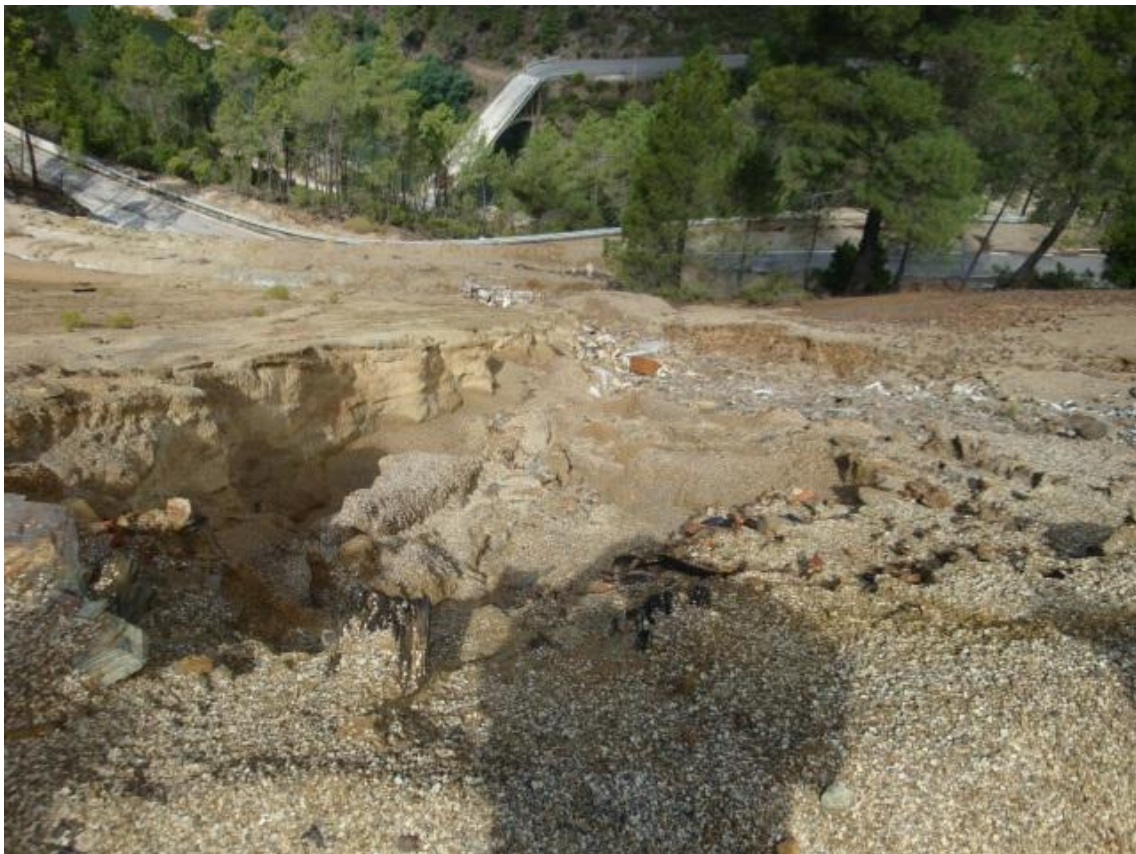
Figura 36 - Desmoronamento do talude na estrada de acesso à barragem de lamas.
