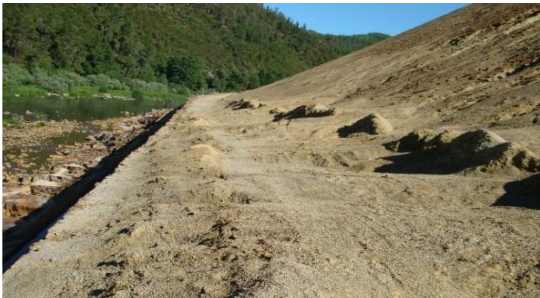
Figura 48 - Estado do talude inferior da barragem e a sua proximidade ao rio.
