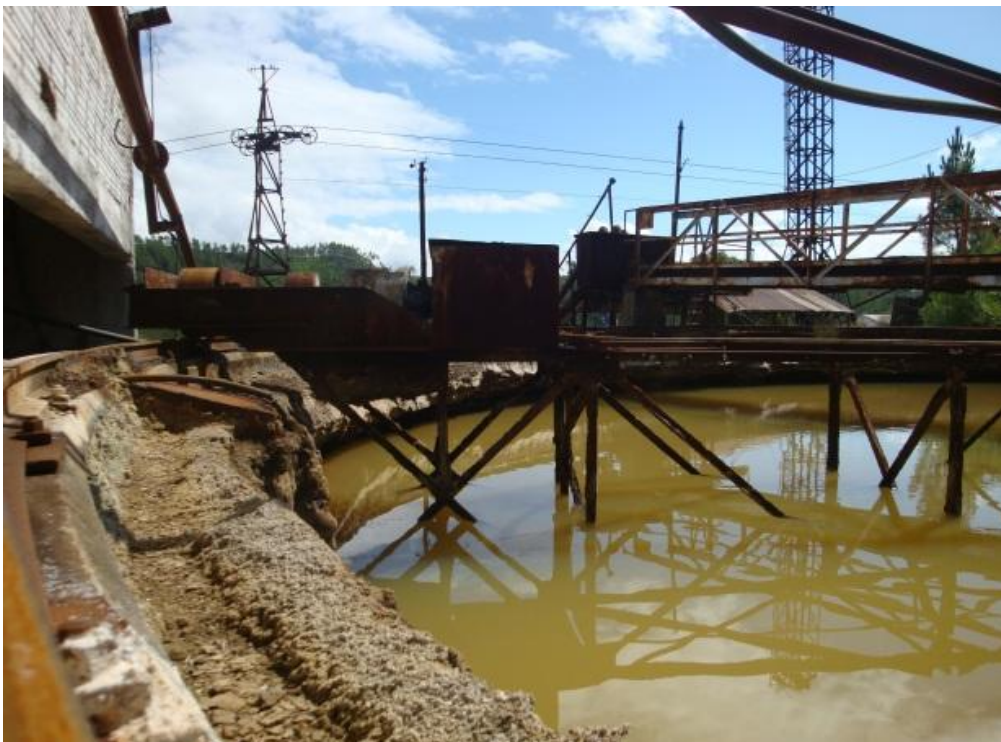
Figura 26 - Bordo do tanque de neutralização e estrutura obsoleta de mistura.
