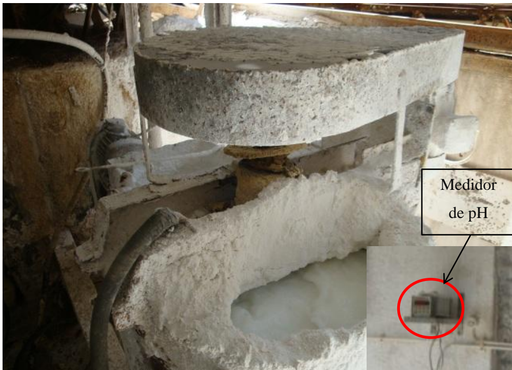
Figura 27 - Máquina de mistura da cal com água potável e o medidor de pH existente.
