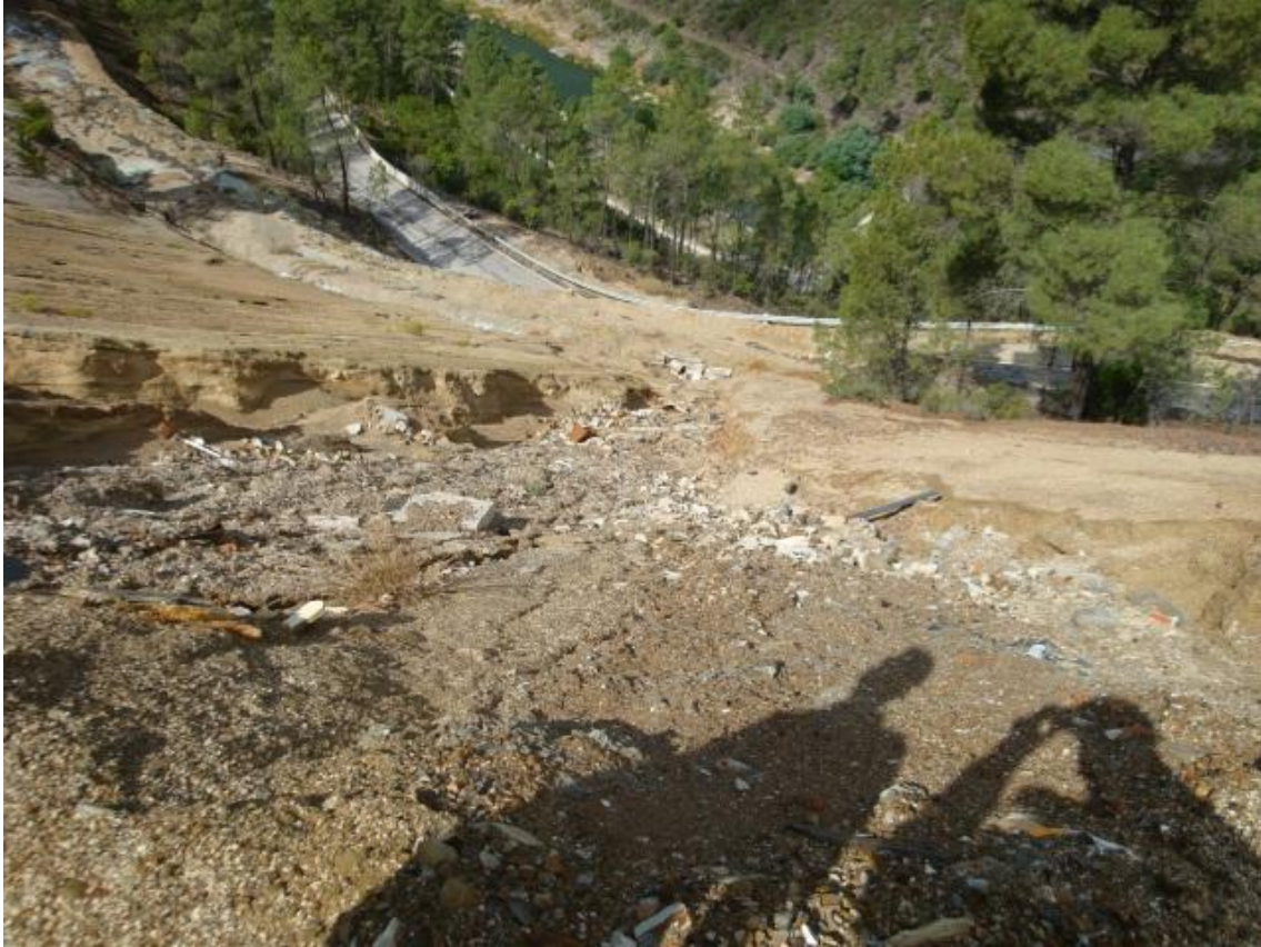
Figura 35 - Degradação da berma da via de circulação.
