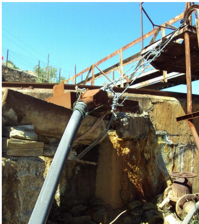
Figura 28 - Canal de descarga da água neutralizada.
