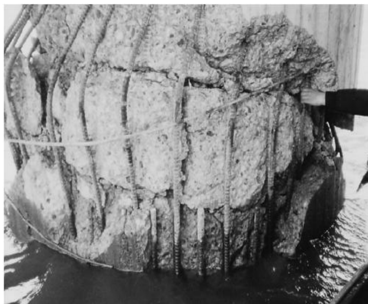
Fig. 2.11 – Sismo de Urakawa-Oki, 1982 (Japão). Dispensa prematura de armadura longitudinal.
