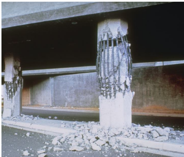
Fig. 2.14 – Sismo de San Fernando, 1971 (EUA). Sub-dimensionamento de armadura transversal.
