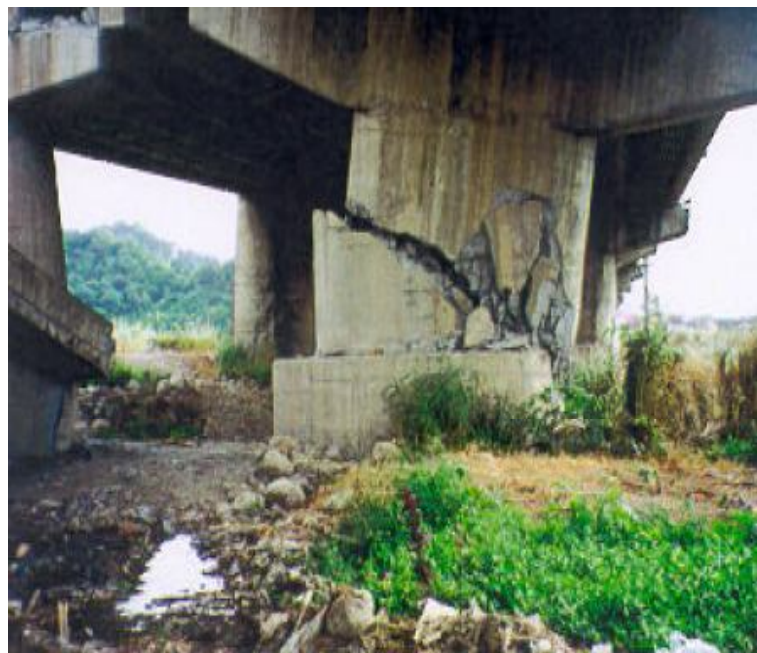
Fig. 2.19 – Sismo de 1999 (Taiwan). Rotura frágil por corte
