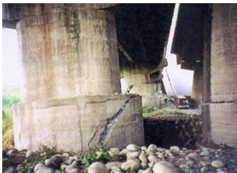
Fig. 2.23 – Sismo de 1999 (Taiwan). Rotura da fundação – Esforço transverso.
