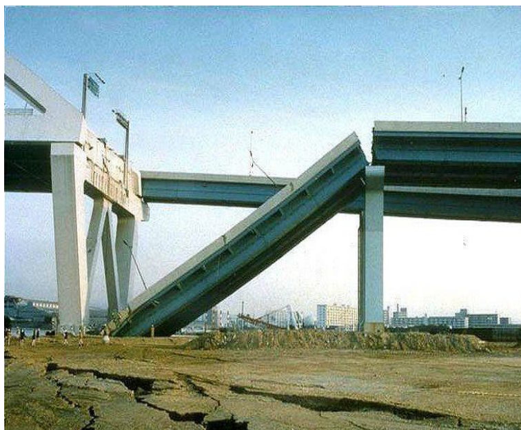
Fig. 2.5 – Sismo de Kobe, 1995 (Japão). Queda de tabuleiro da Ponte Nishinomiya.
