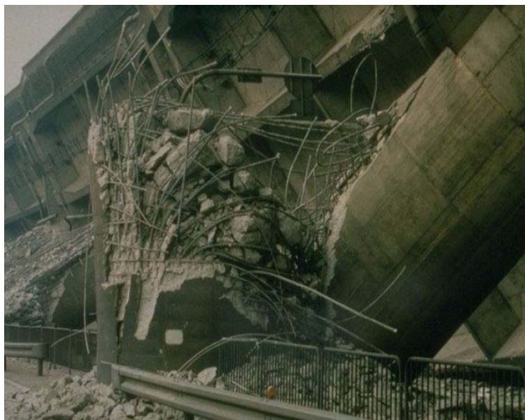
Fig. 2.12 – Sismo de Kobe, 1995 (Japão). Dispensa prematura de armadura longitudinal.
