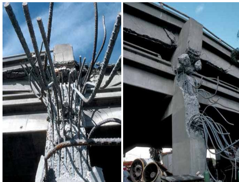
Fig. 2.22 – Sismo de Loma Prieta, 1999 (EUA). Má concepção dos nós – Esforço transverso.
