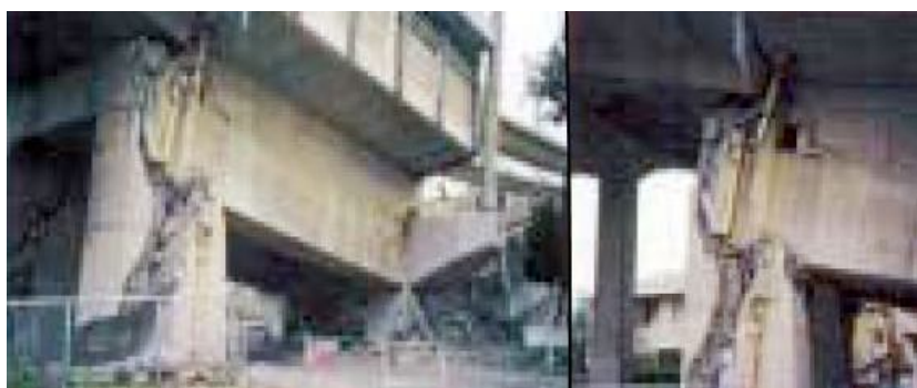
Fig. 2.9 – Sismo de 1999 (Taiwan). Danos nos encontros.
