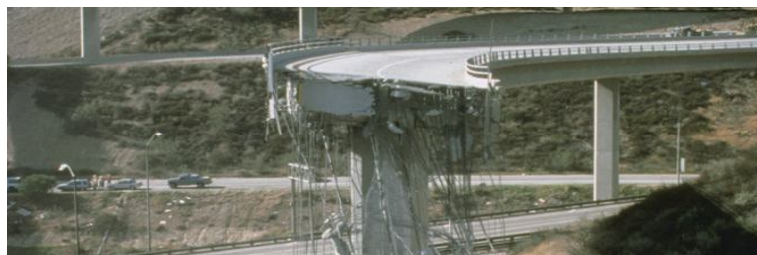
Fig. 2.2 – Sismo de San Fernando, 1971 (EUA). Deslocamento longitudinal excessivo.
