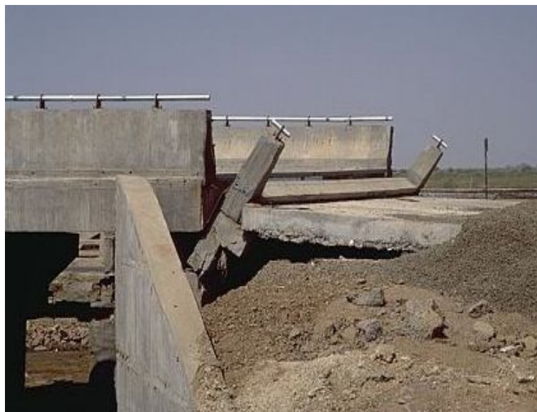
Fig. 2.10 – Sismo de Gujarat, 2001 (Índia). Impacto do tabuleiro sobre o encontro.
