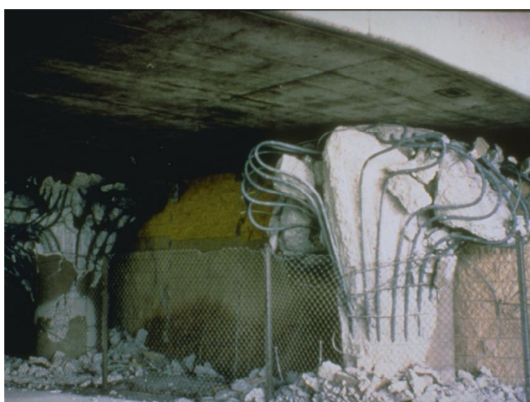
Fig. 2.13 – Sismo de Northridge, 1994 (EUA). Armadura transversal insuficiente.
