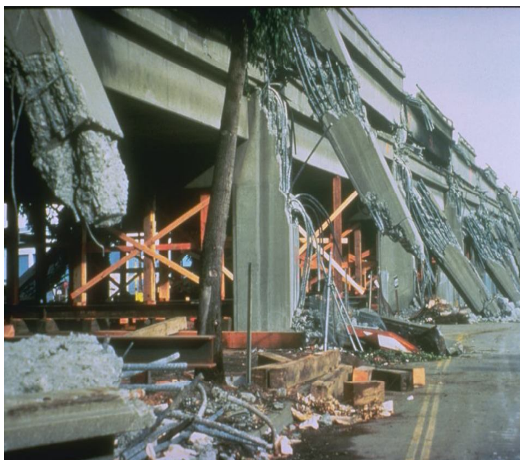
Fig. 2.21 – Sismo de Loma Prieta, 1999 (EUA). Má concepção dos nós – Esforço transverso.
