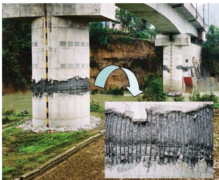
Fig. 2.15 – Sismo de Niigata (Japão). Armadura transversal insuficiente
