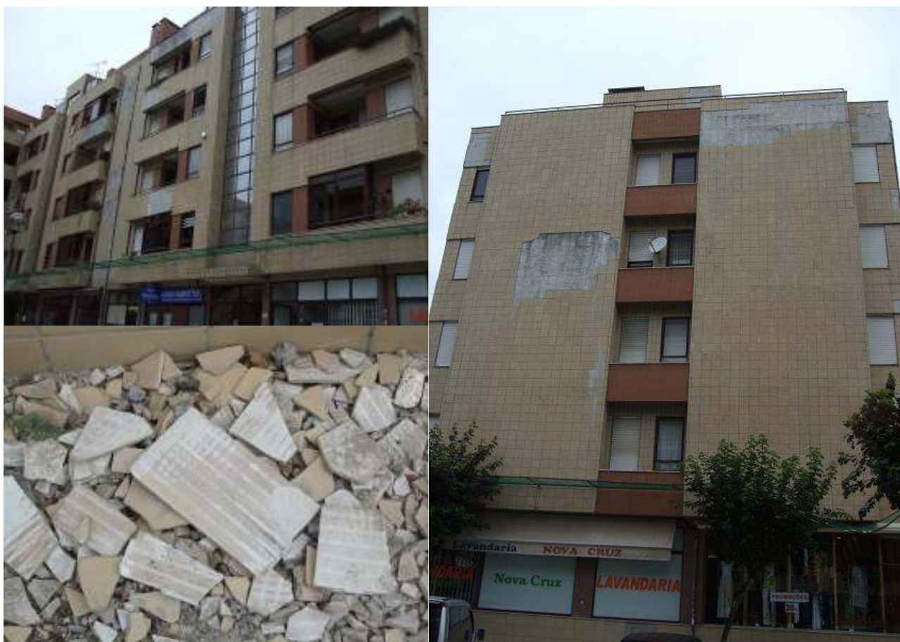
Fig. 4.5 – Edifício em Santa Maria da Feira com descolamento generalizado
