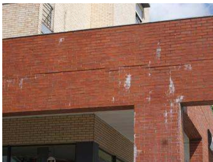
Fig. 4.12 – Revestimento cerâmico com fissuras nas juntas e desnivelamento, devido a movimento diferenciais no suporte, e com eflorescências
