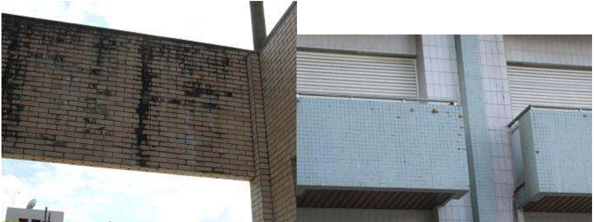
Fig. 4.16 – Revestimento cerâmico com anomalias estéticas provocadas por fungos
