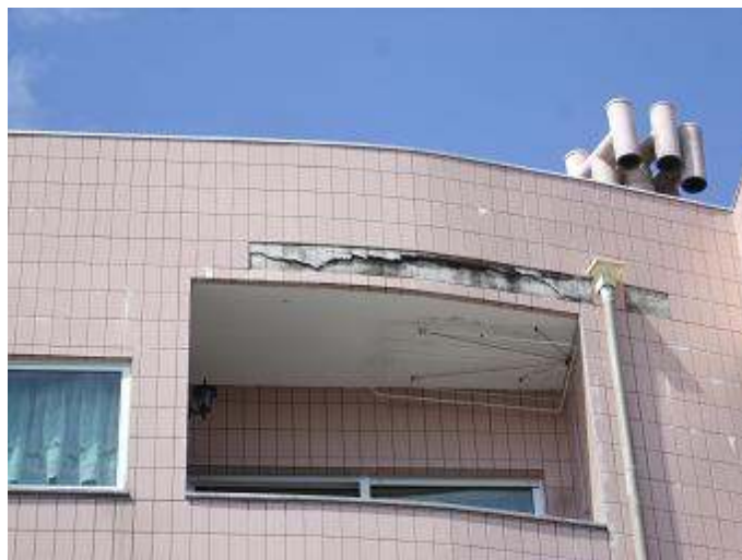
Fig. 4.11 – Revestimento cerâmico com descolamento pontual devido a fissuras provocadas pelos movimentos diferenciais no suporte na ligação laje-platibanda
