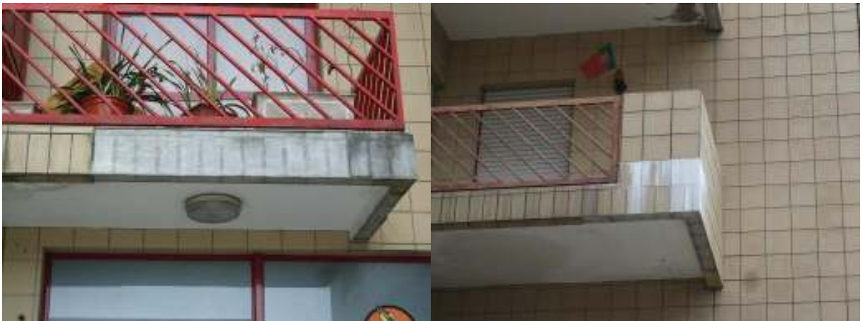
Fig. 4.23 – Descolamento em zona muito exposta (fig. esquerda) e escoamento grave (fig. direita) devido à falta de capeamento superior de protecção contra a água
