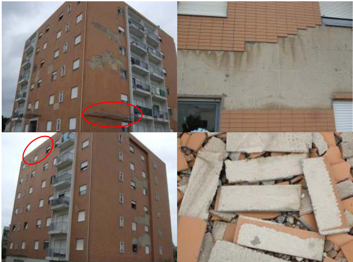
Fig. 4.4 – Edifício em Mozelos com descolamento generalizado
