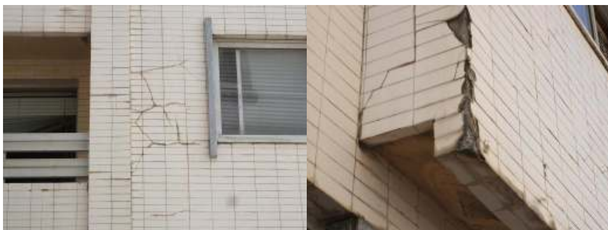
Fig. 4.20 – Fissuração dos ladrilhos, devido à fendilhação do suporte, ou movimentos diferenciais suporte-revestimento, ou contracção/expansão do produto de assentamento dos ladrilhos; na figura da direita as arestas foram alvo de acidente ou vandalismo
