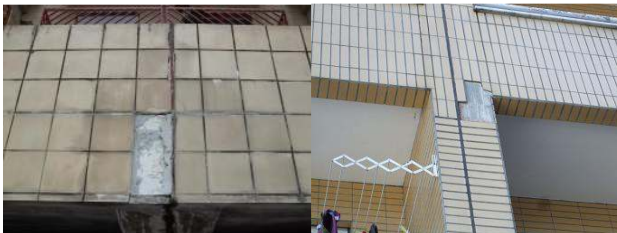
Fig. 4.19 – Juntas de dilatação estrutural com funcionamento ineficaz para o revestimento
