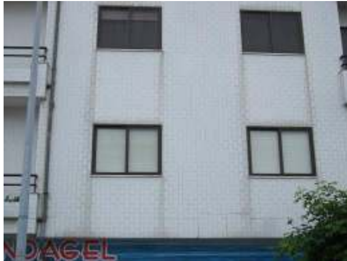
Fig. 4.22 – Sujeidade no revestimento e nas juntas devido à acção da água da chuva nos peitoris das janelas
