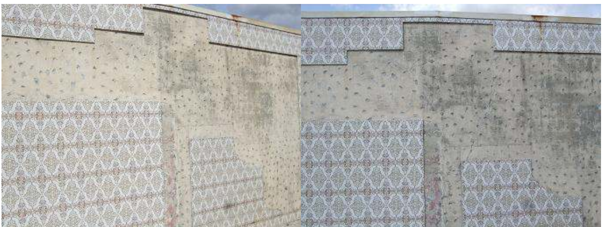
Fig. 4.18 – Descolamento por falta de aderência da cola ao suporte devido à picagem “pontual” da camada de reboco pintado ser insuficiente para garantir aderência da cola ao suporte
