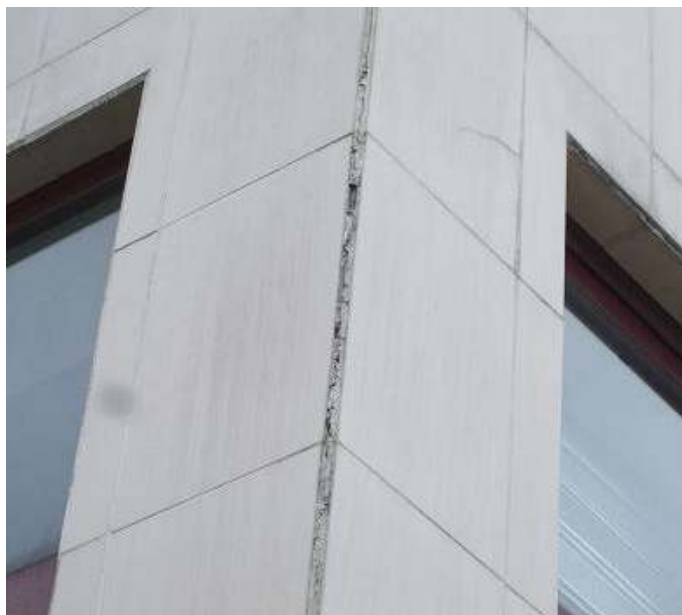
Fig. 4.25 – Degradação de aresta sem protecção, onde são visíveis fissuras no produto aplicado no remate e dessolidarização.
