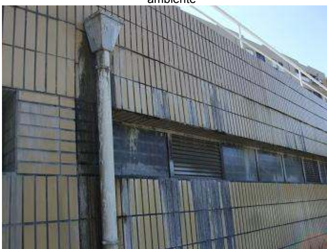
Fig. 4.15 – Revestimento cerâmico com anomalias estéticas provocadas por escorrimentos da água do terraço (impermeabilização degradada) devido à fissuração do suporte na ligação viga-murete de protecção
