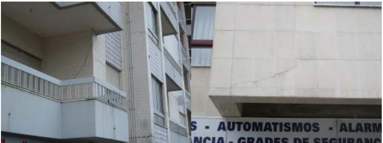
Fig. 4.17 – Fissuração do RCA devido à rotação da laje em consola, acentuada pela sujeira acumulada na fissura
