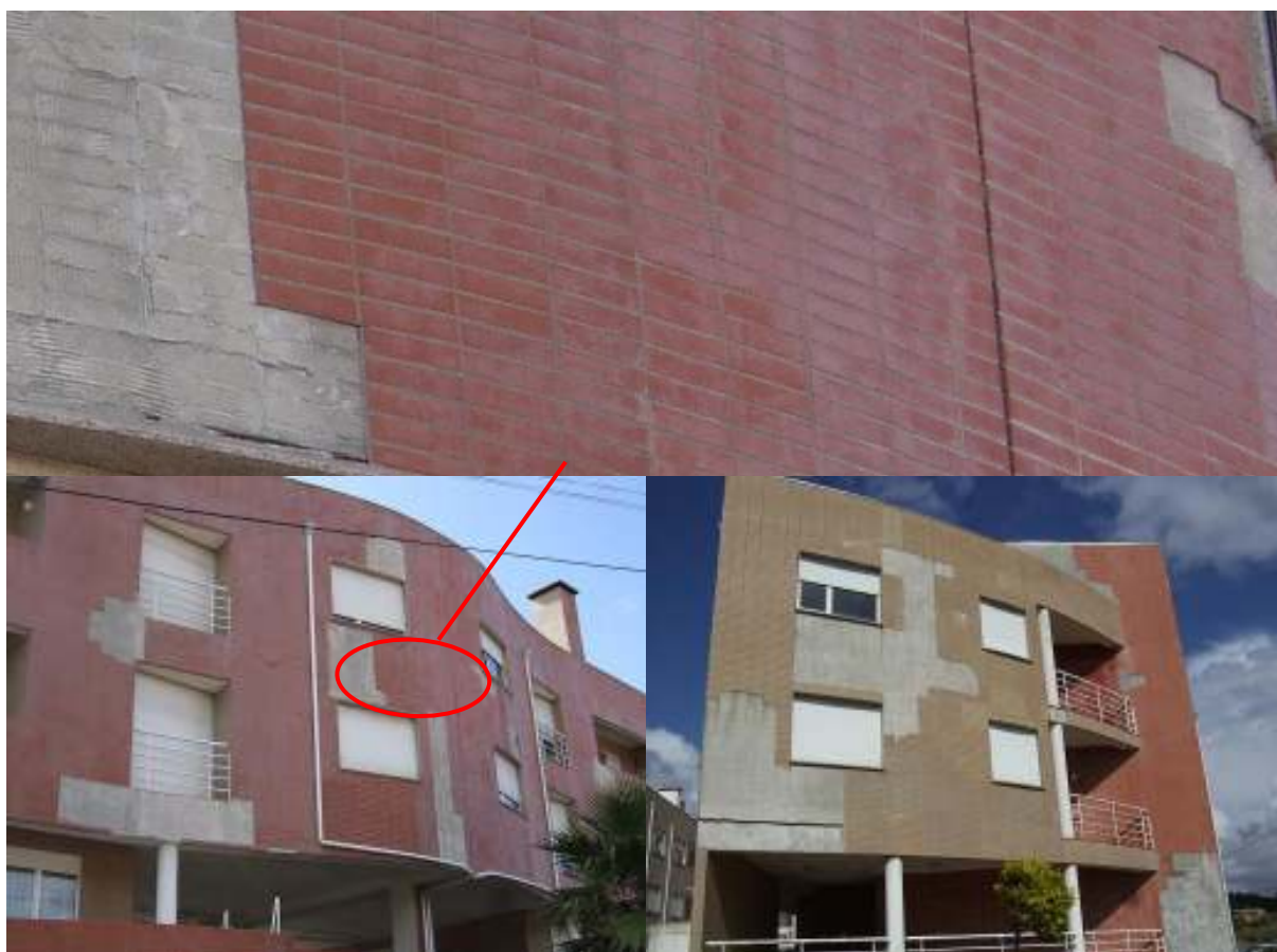
Fig. 4.3 – Edifício em São Félix da Marinha com várias patologias no sistema RCA. Na fig. lado esquerdo visível a fachada Norte e na fig. lado direito visível a fachada Sul
