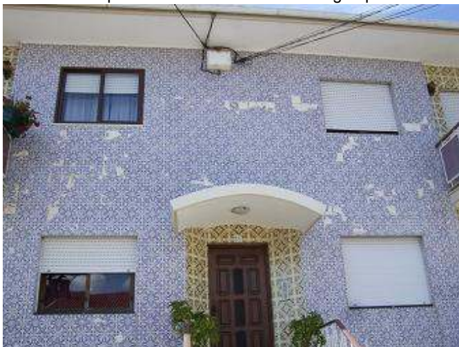
Fig. 4.14 – Revestimento cerâmico com anomalias estéticas devido ao desprendimento do vidrado por agressões do meio ambiente
