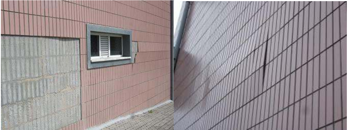
Fig. 4.6 – Revestimento cerâmico com empolamento e posterior descolamento, associados à elevada expansão dos ladrilhos, à falta de qualidade do material de colagem, a erros sistemáticos de aplicação ou à incompatibilidade entre as várias camadas do sistema
