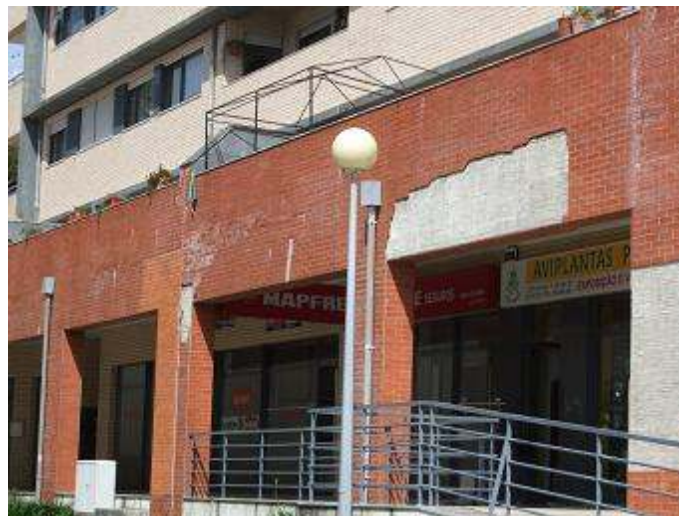
Fig. 4.7 – Revestimento cerâmico com descolamento e defeitos quanto ao aspecto: eflorescências e alteração da cor de alguns ladrilhos devida à reparação anterior
