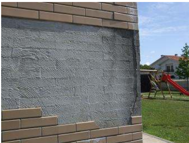
Fig. 4.13 – Revestimento cerâmico com descolamento devido a fissura do suporte no cunhal e entrada de água para o tardo
