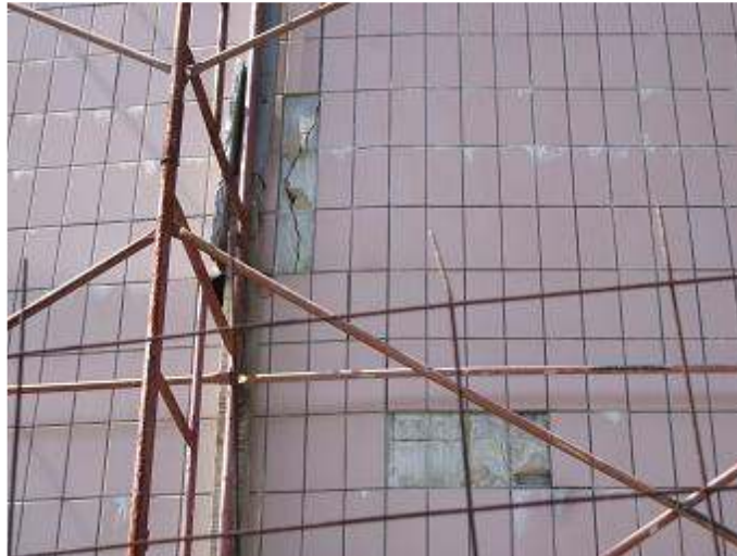
Fig. 4.10 – Revestimento cerâmico com descolamento pontual devido a fissuras no suporte e eflorescências
