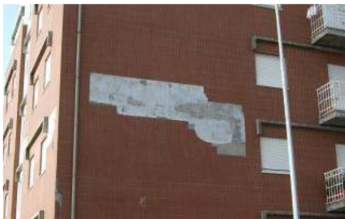
Fig. 4.9 – Revestimento cerâmico com descolamento pontual com grande expansão devido à rotura coesiva do suporte
