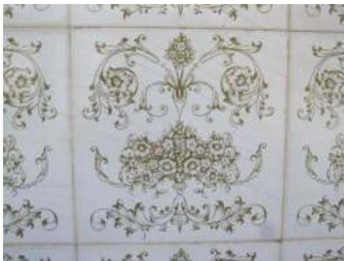
Fig. 4.24 – Aspecto de fissuração de azulejos exteriores no seu vidroado
