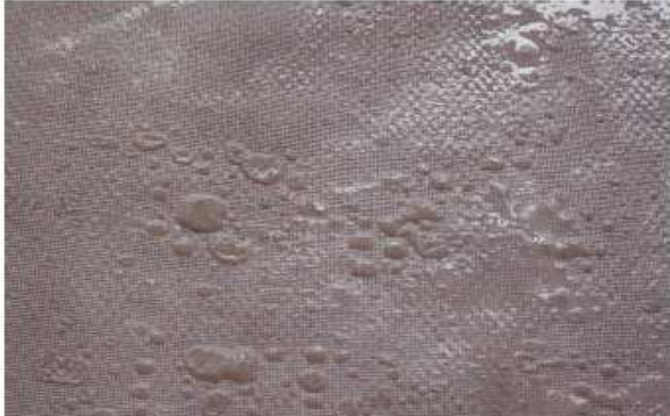
Figura 43 - Membrana danificada por formação de blisters
