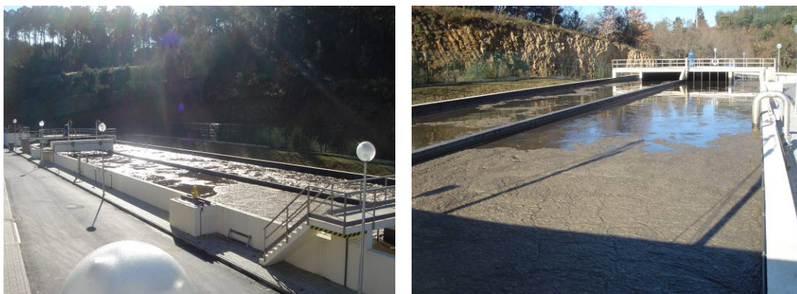
Figura 8 - Reactor Biológico – Vala de Oxidação, do tipo Carroucel .
