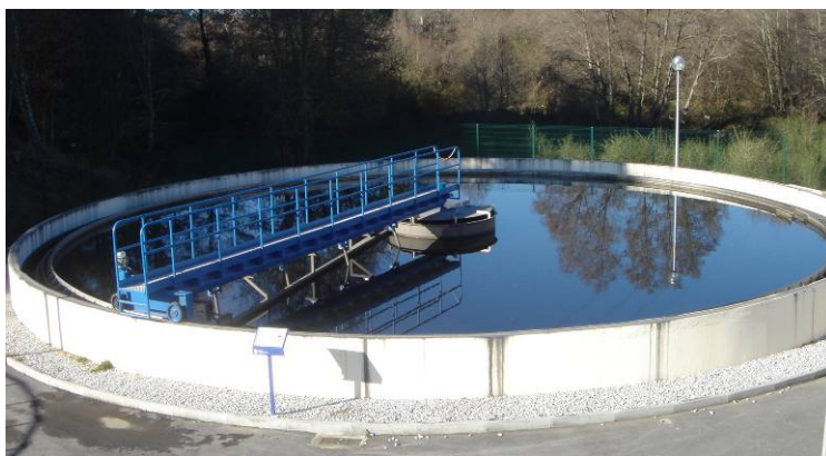
Figura 15 - Decantador Circular, presente no processo de tratamento de água residual, afluente à ETAR de Seia
