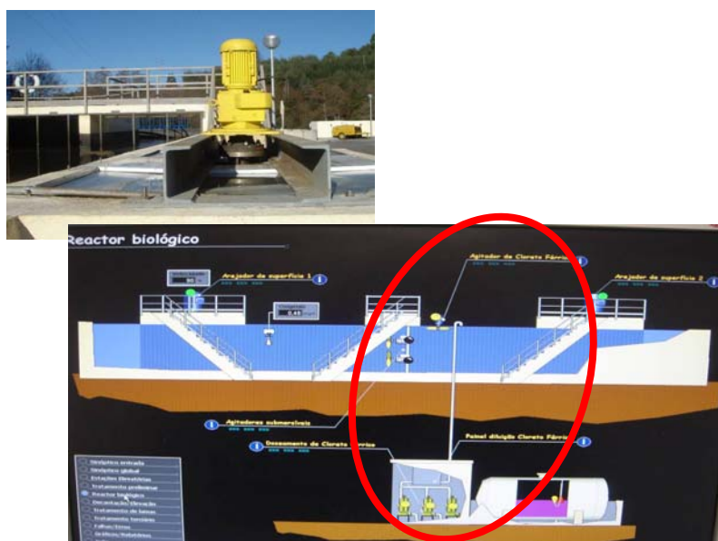
Figura 13 -Bomba responsável pela admissão de cloreto férrico, ao reactor biológico.
