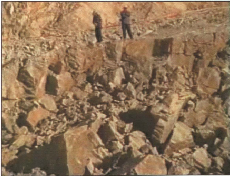
Foto 24- Carregador de fogo e operador do carro de perfuração, inspeccionam o material resultante da detonação.
