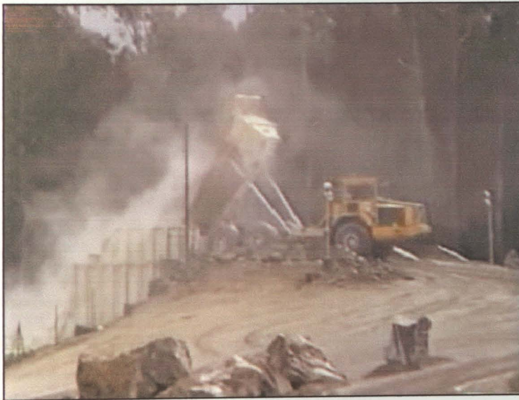
Foto 37- Dumper de 35 Toneladas a efectuar operação de descarga na tremonha de um dos primários na pedreira da Malaposta
