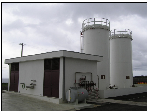
Figura 2.3 - Sistema de armazenagem de combustível
