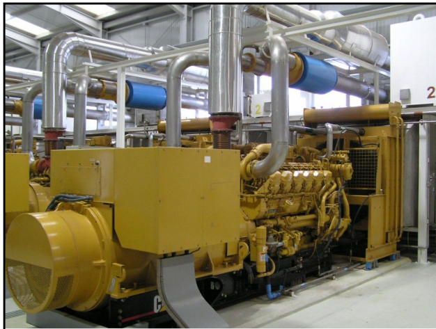
Figura 2.2 - Grupo Termoeléctrico n.º5
