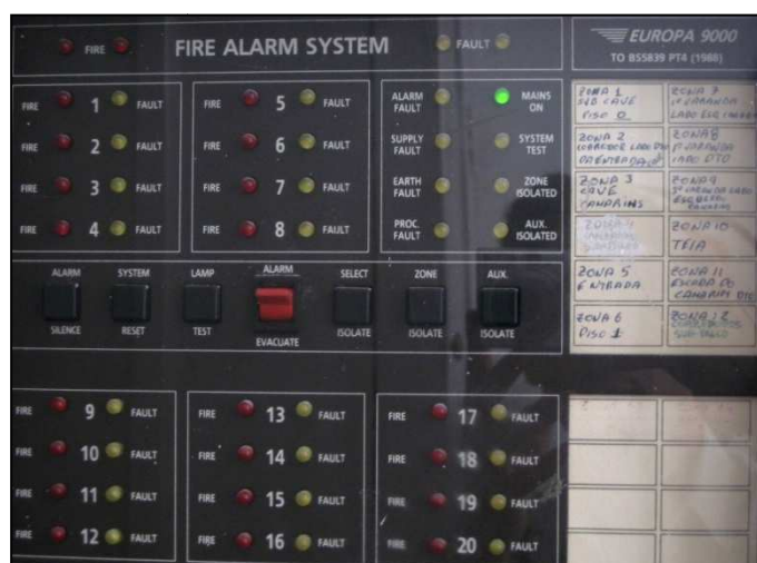
Fig. 7.2. – Quadro de controlo do sistema de detecção de incêndio do Teatro Politeama
