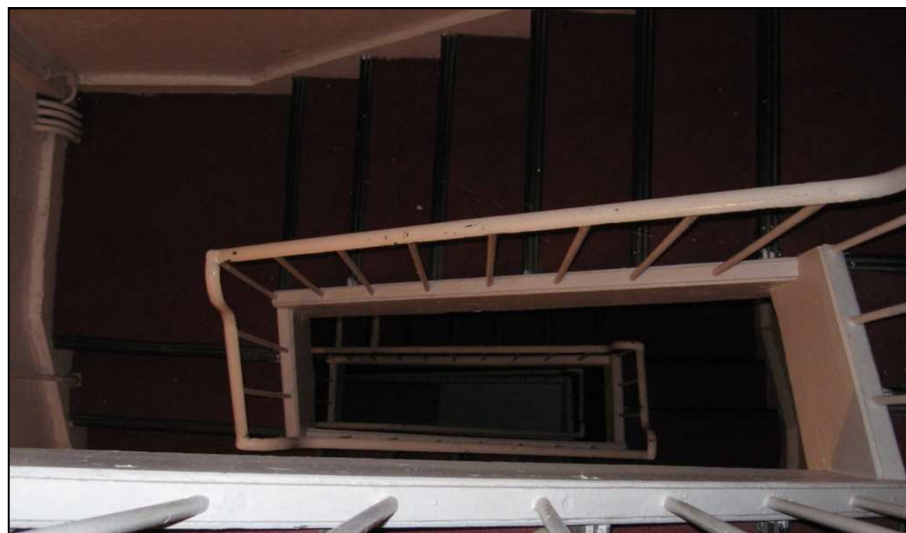
Fig. 5.8. – Escada incluída numa via de evacuação vertical do Teatro Politeama
