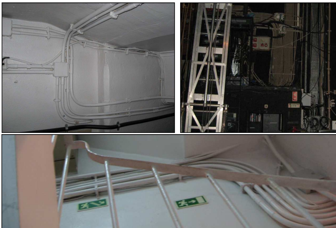
Fig. 4.4. – Algumas canalizações de instalações técnicas do Teatro Politeama
