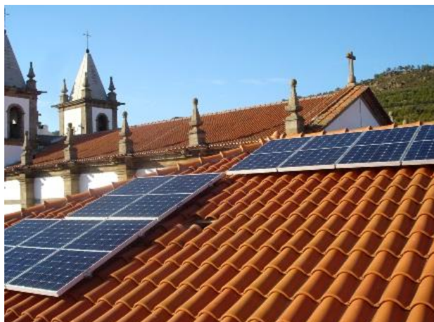
Figura 4.1 - Microprodução fotovoltaica num telhado de uma habitação [16]
