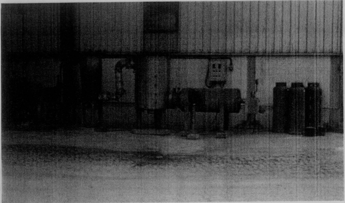
Figura 3 – Instalação piloto de incineração
