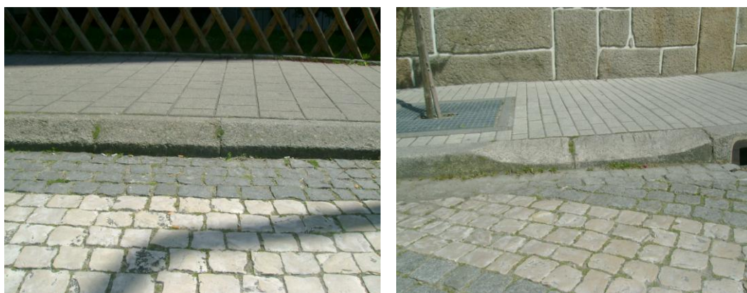
Fig. 3.28. – Travessias com rampas sem condições para peões em cadeira de rodas
