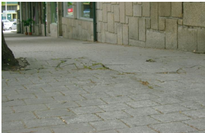
Fig. 3.23. - Passeio em mau estado de conservação (zona 2b)
