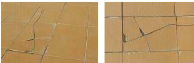
Fig. 2.9 - Exemplos de fissuração [1]
