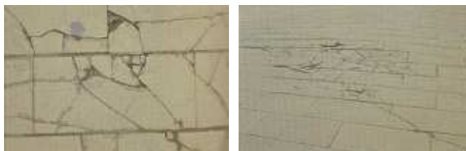
Fig. 2.10 - Exemplos de patologias devidas à deformação do suporte [1]
