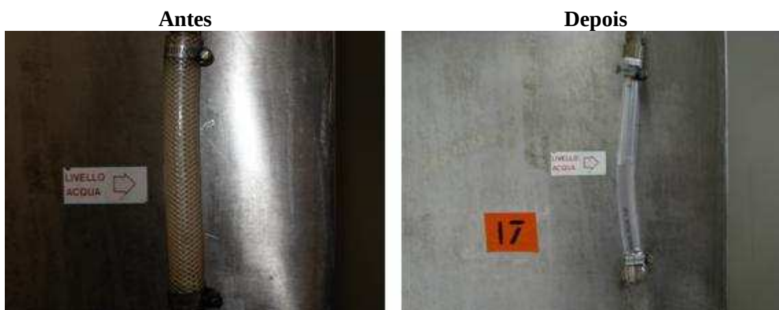
Figura 33 – Identificação visual do nível de água do lavador de gases
