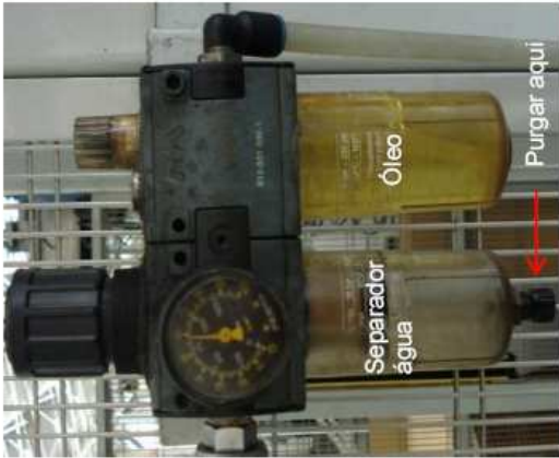
Fig. 32 - Separadores de água e lubrificadores do ar
