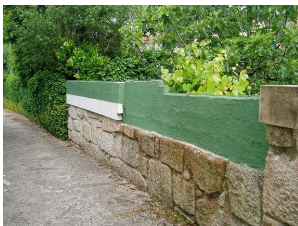
Fig.8 – Obra de escassa relevância urbanística (muro divisório)
