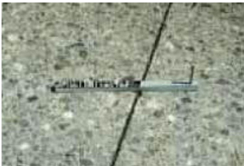
Foto 3.36 – Defeitos de selagem das juntas ou fendas. Branco et al (2006)
