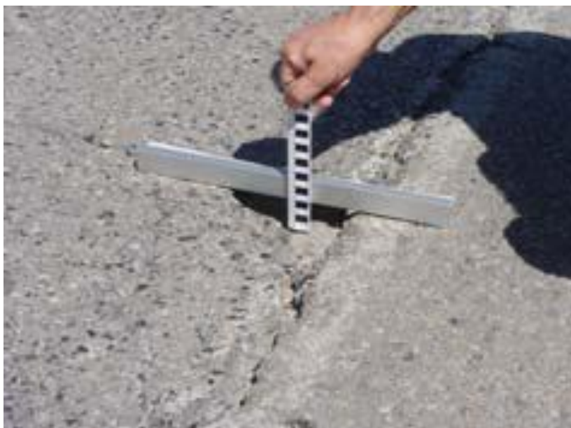
Foto 3.4 – Abatimento longitudinal no eixo [7]
