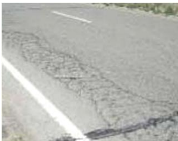
Foto 3.10 – Fendas de fadiga [7]
