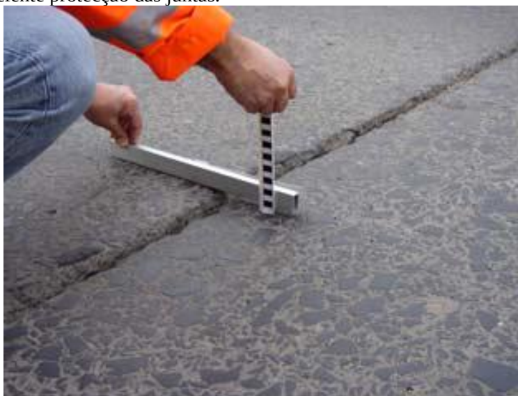
Foto 3.30 – Escalonamento das lajes (deformação) [7]
