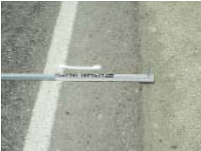
Foto 3.3 – Abatimento longitudinal na berma [7]
