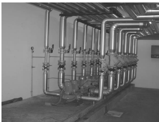
Figura 2.4 - Fotografia de bombas de circulação da marca Wilo , de um edifício da PT Comunicações.
