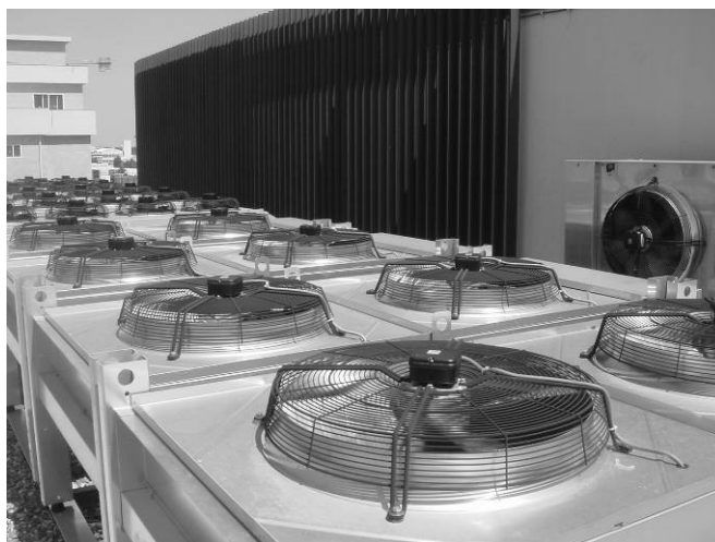
Figura 2.5 - Fotografia dos ventiladores de unidades compactas da Liebert Hiross , do edifício da PT Comunicações na Rua do Tenente Valadim, Porto.
