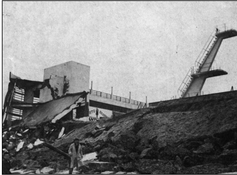
Figura 4.8 – Destruição parcial da piscina municipal, 1949 ( EUrosion , 2006).
