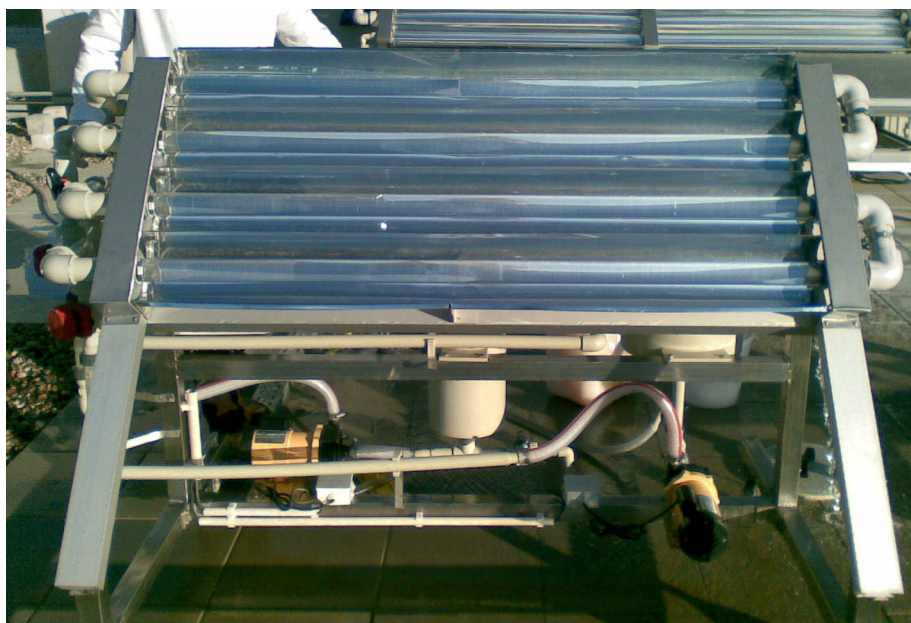
Figura 3. Instalação piloto com CPC instalada na cobertura do DEQ, FEUP.
