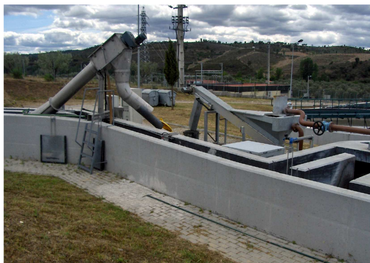
Figura 14. Obra de entrada da ETAR de Mirandela.
