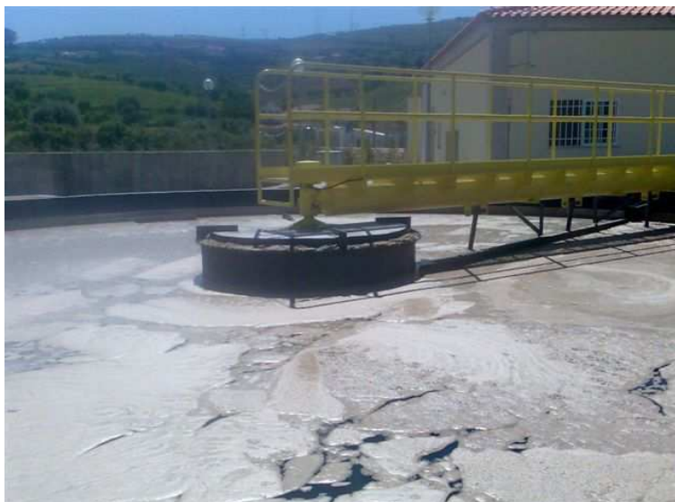
Figura A 1. Decantador ETAR de Cambres.
