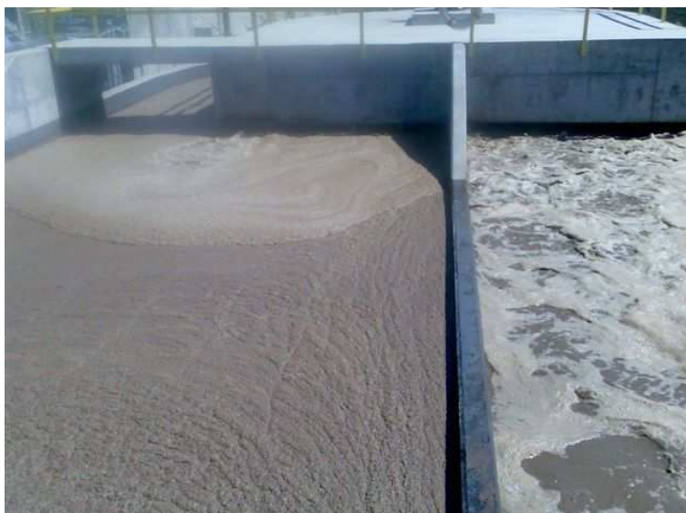
Figura A 2. Tanque de arejamento ETAR de Cambres.
