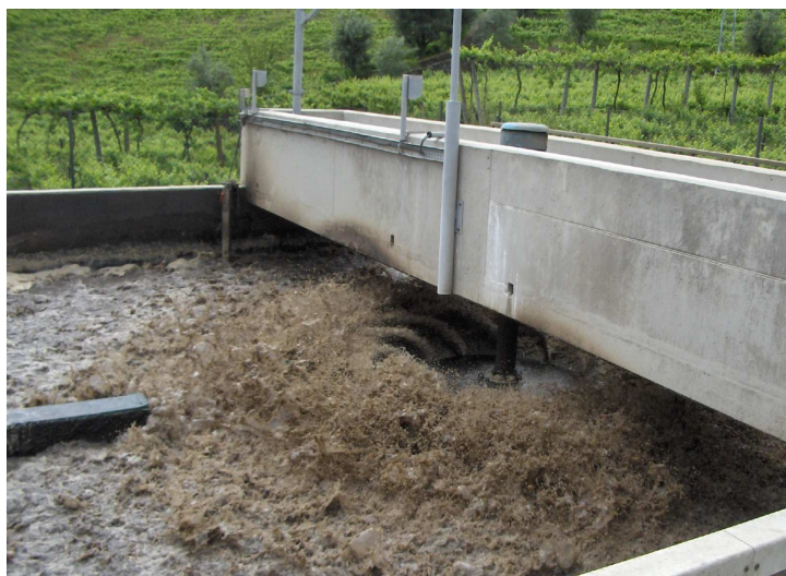
Figura 4. Vala de oxidação da ETAR de S. Miguel de Lobrigos.
