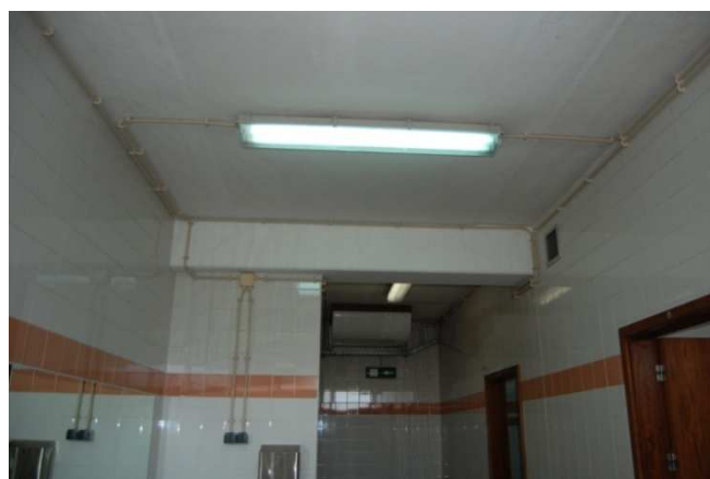
Figura 5.18 - Luminárias do corredor e casa de banho dos pavilhões gimnodesportivos (modelo M2).
