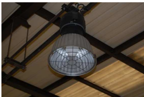
Figura 5.15 - Luminária do pavilhão ginnodesportivo das escolas do modelo M1.
