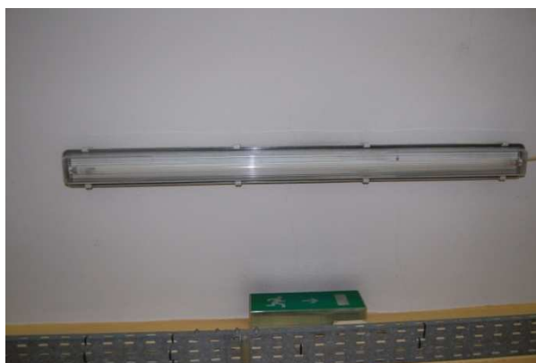
Figura 5.16 - Luminárias do corredor e casa de banho dos pavilhões ginnodesportivos (modelo M1).
