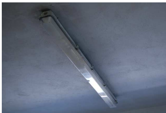
Figura 5.14 - Pormenor da luminária característica das casas de banho.
