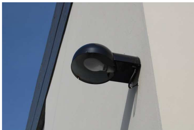
Figura 5.23 - Luminária esférica, tipo applique, fixada numa fachada.
