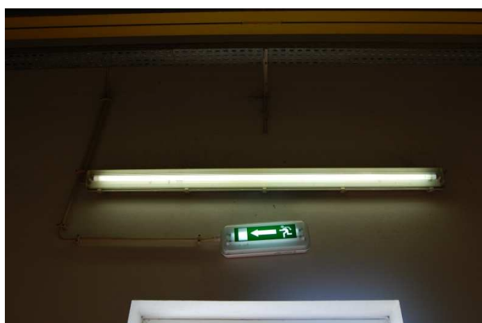
Figura 5.20 - Exemplo de luminária do corredor e casa de banho do pavilhão gimnodesportivo da escola E.3.1.
