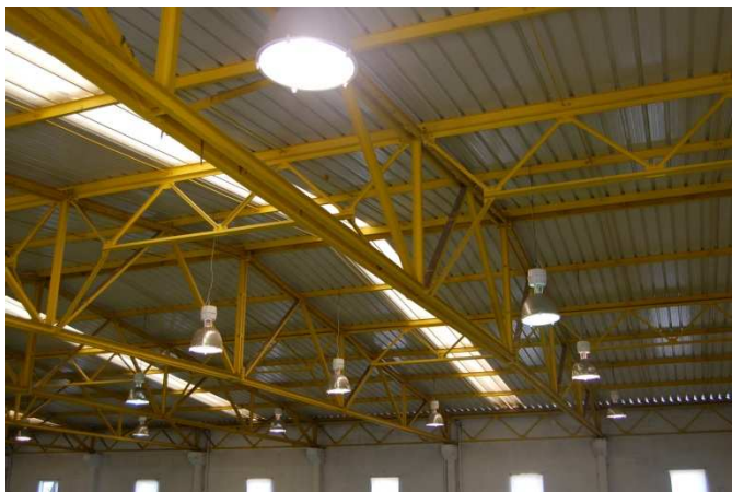
Figura 5.19 - Luminárias do pavilhão gimnodesportivo da escola E.3.1.
