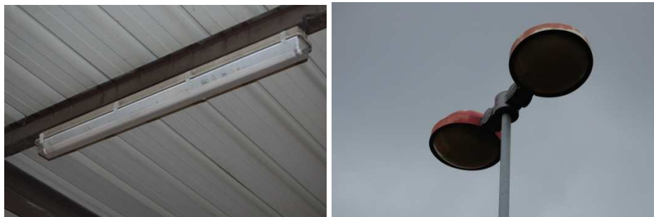
Figura 5.21 - Luminárias de iluminação exterior (modelo M1).
