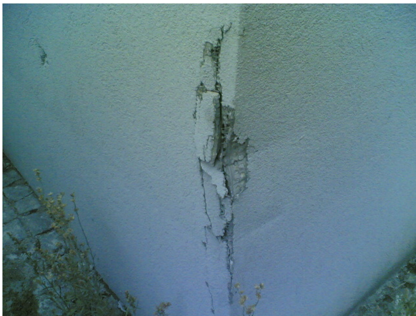
Fig.13 – Sistema ETICS danificado por punçoamento
