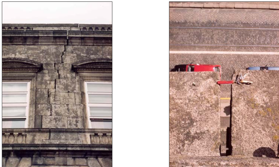
Figura 4.7 – Fendas ao longo das juntas na fachada Sul do Hospital Santo António no Porto (Begonha, 2001)
