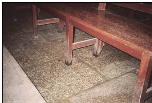
Figura 4.2 – Manchas de humidade no pavimento interior da Igreja do Mosteiro de Travanca – Amarante
