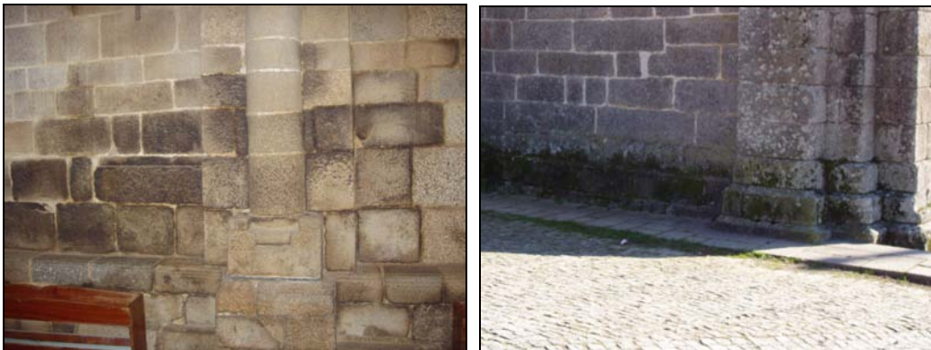
Figura 4.1 – Manchas de humidade nas paredes, no interior e exterior (alçado Norte) da Igreja do Mosteiro de Travanca – Amarante
