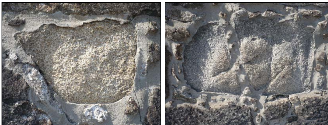
Figura 4.11 – Desagregação granular diferencial devido à aplicação de argamassas de cimento Hospital Santo António – Fachada Sul
