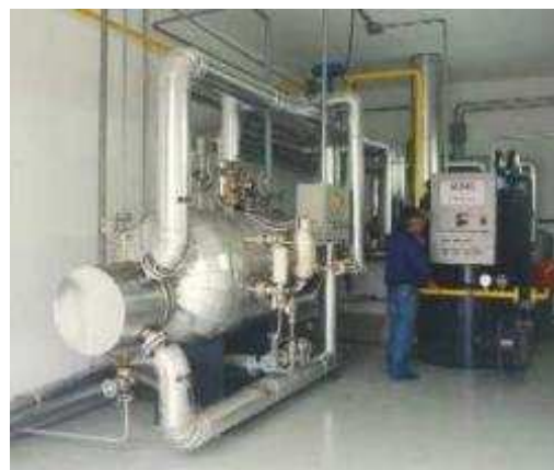
Figura 19. Caldeira de Geração Indirecta
