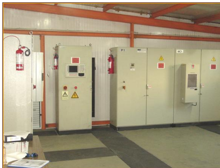
Figura 4.4 – Quadros eléctricos protegidos por Firetrace
