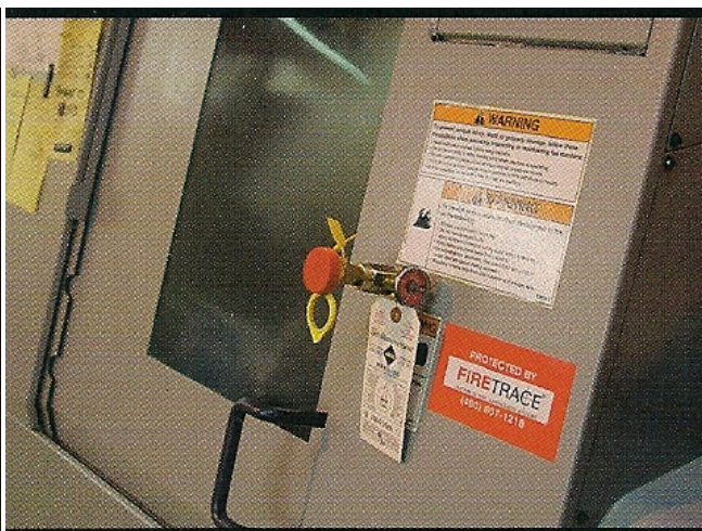
Figura 4.12 – Central de alarme Firetrace
