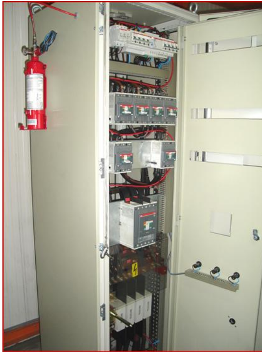
Figura 4.9 – Firetrace aplicado em quadro eléctrico
