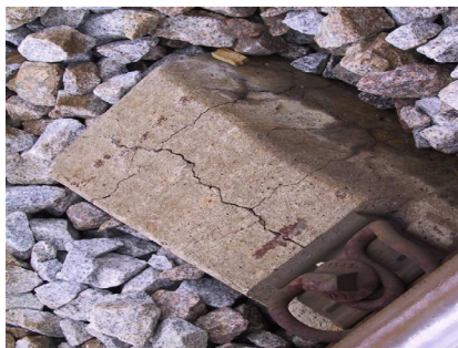
Fig.4 – Deterioração do betão por reacções álcalis-silica reactiva (Santos Silva, 2007).
