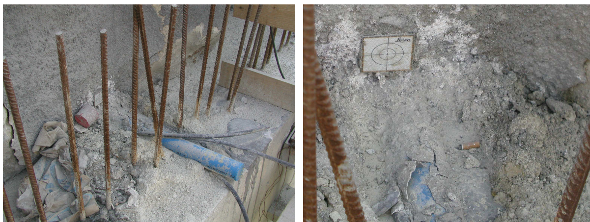
Figura 4.8 – Pormenor do inclinómetro horizontal com o alvo situado na viga de coroamento.
