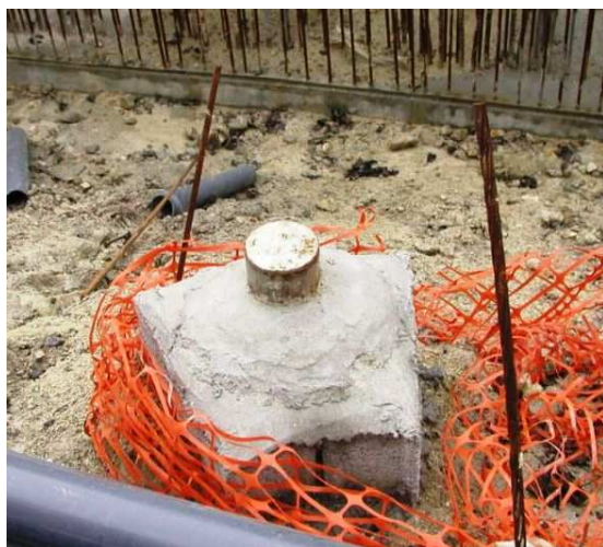
Figura 2.14 – Exemplo de um piezómetro instalado na obra.
