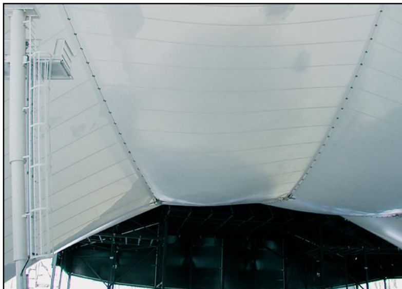
Fig.5.2. – Ponding numa cobertura em tela – Pennsylvania, EUA
