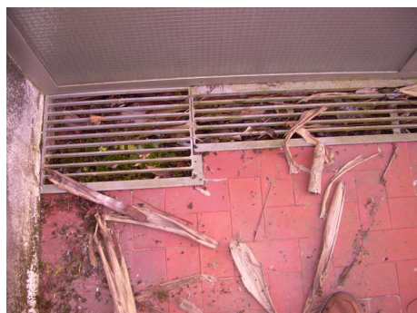
Figura 5.6 – Sujidade na zona da caleira.
