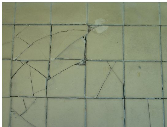
Figura 5.21 – Ladrilhos cerâmicos fissurados e quebrados
