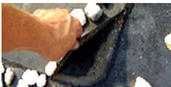
Figura 5.9 – Descolamento da junta de sobreposição das membranas [31].
