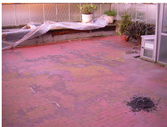
Figura 5.22 – Eflorescências em ladrilhos cerâmicos
