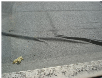
Figura 5.8 – Pregas na membrana de impermeabilização.
