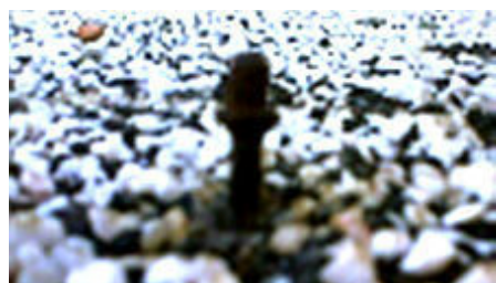
Figura 5.4 – Perfuração do revestimento de impermeabilização [31].
