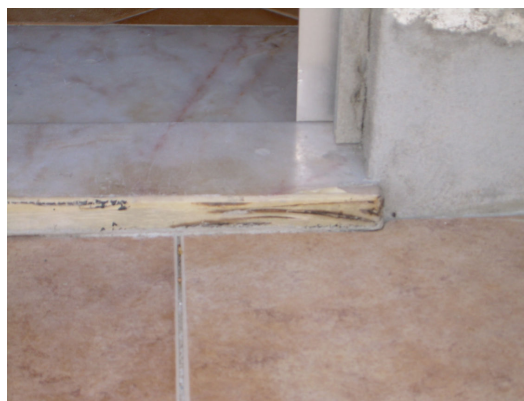
Figura 5.14 – Insuficiente cota da soleira
