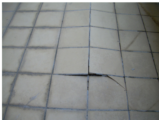
Figura 5.19 – Descolamento com empolamento de ladrilhos cerâmicos
