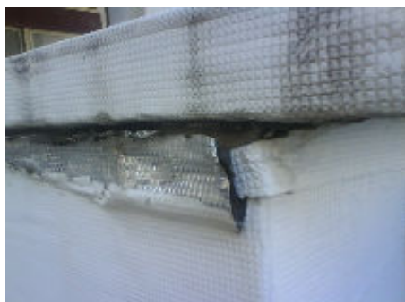
Figura 5.10 – Descolamento do remate de impermeabilização [31].
