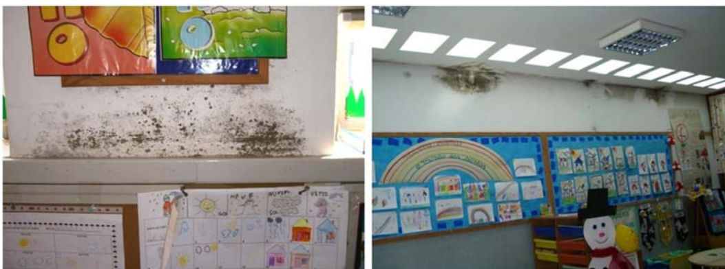
Figura 17: Problemas de infiltrações e contaminação fúngica de materiais de construção no JI-B (à esquerda) e no JI-D (à direita)
