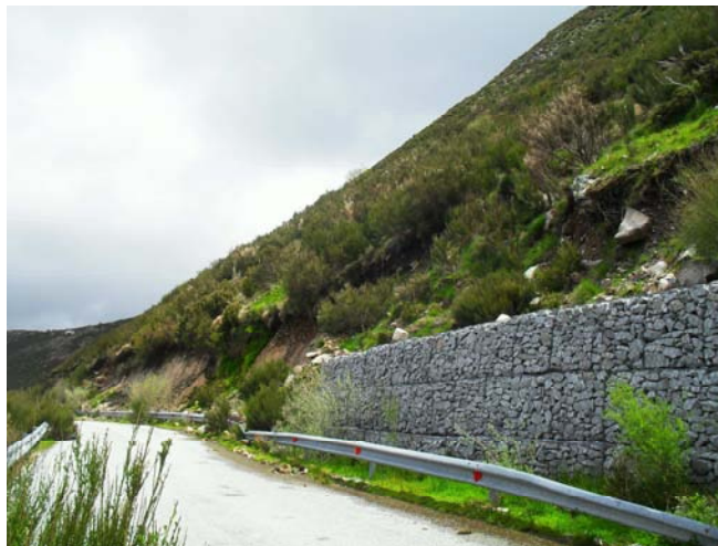
Queda de detritos
