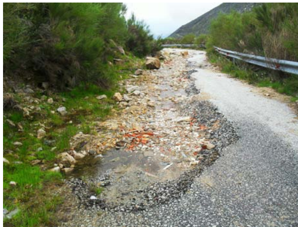
Fig: queda de detrito( detalhe)
