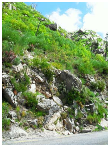
Queda de detritos nas laterais
