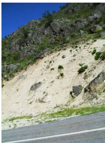
Queda de detritos
