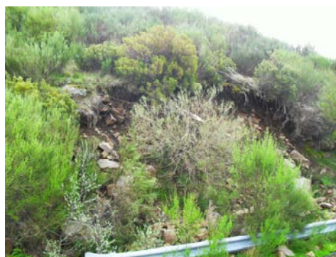
Queda de detritos
