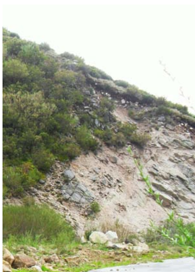
Queda de detritos
