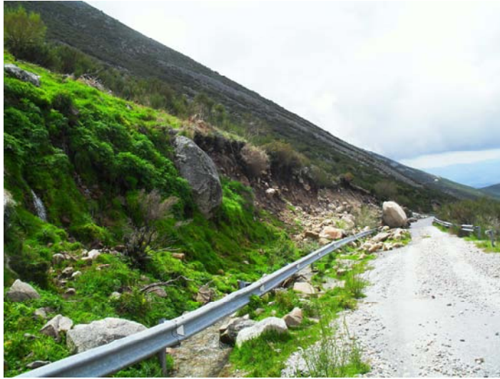
Queda de detritos
