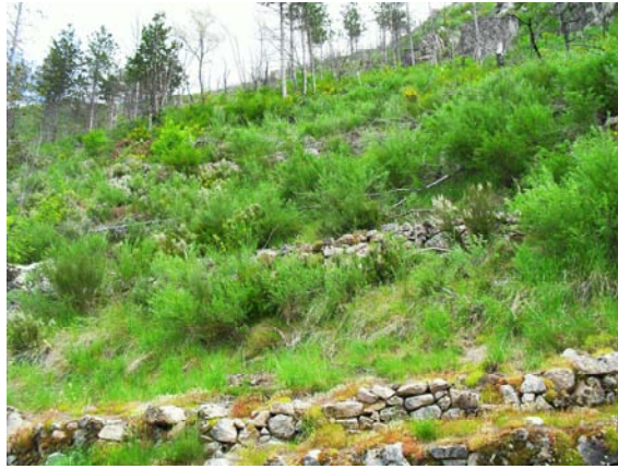
Queda de detritos
