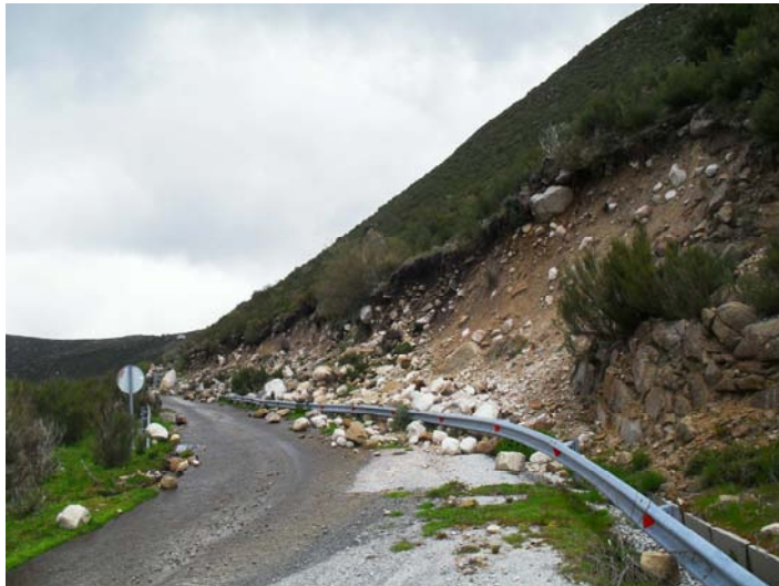
Queda de detritos
