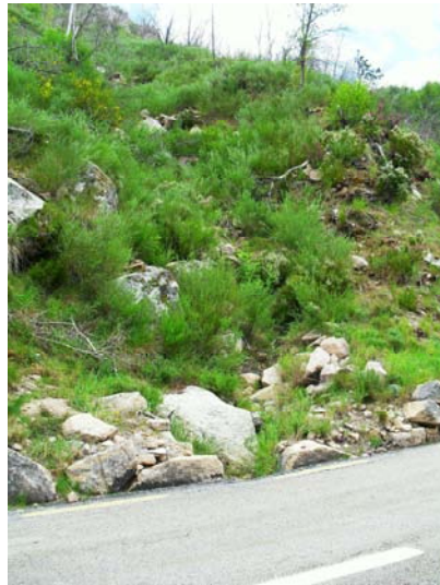
Queda de detritos
