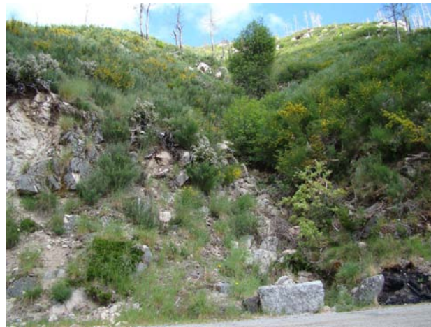
Queda de detritos nas laterais
