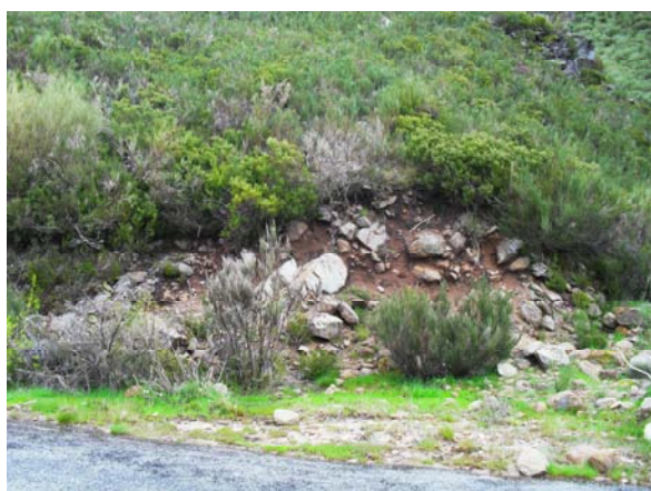
Queda de detritos, detalhe
