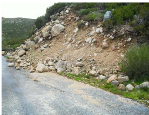
Queda de detritos
