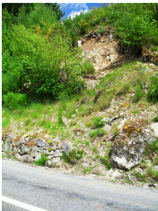
Queda de detritos
