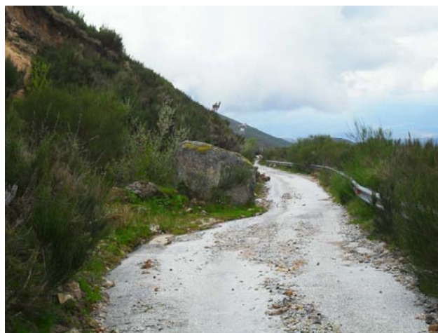
Queda de detritos, detalhe
