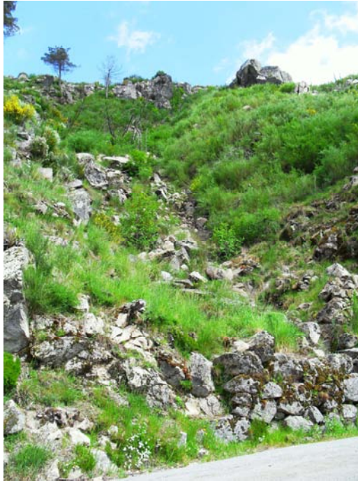
Queda de detritos nas laterais
