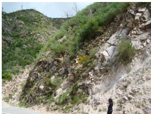
Queda de detritos na lateral
