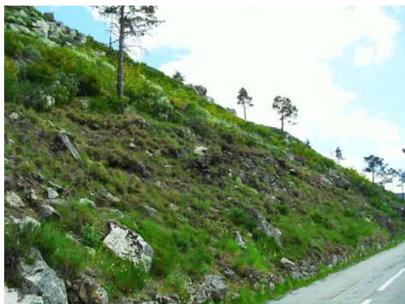
Queda de detritos
