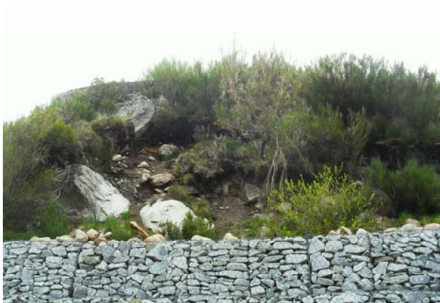
Queda de detritos
