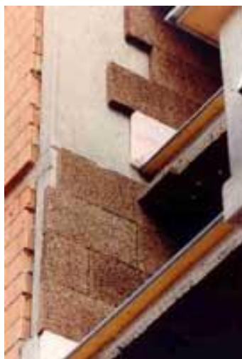
Figura 2.7: Revestimento exterior de fachada com placas de cortiça expandida [33] .
