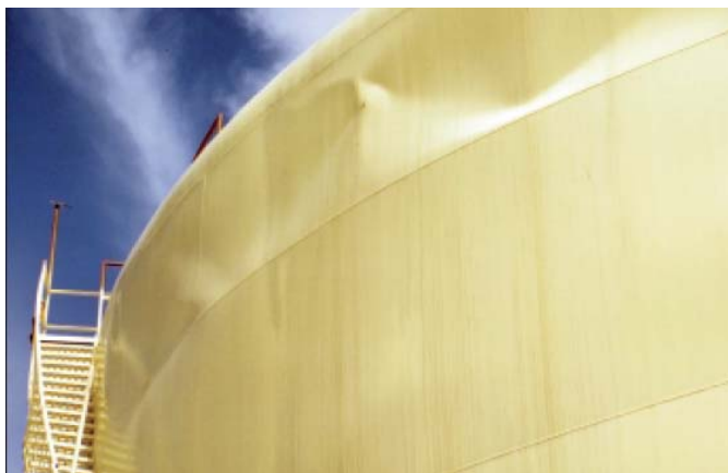
Figura 7 – Deformação da parte superior da parede do tanque devido a sucções originadas pela oscilação do líquido
