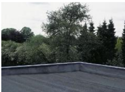
Fig.2.5 - Anomalias em cobertura plana
