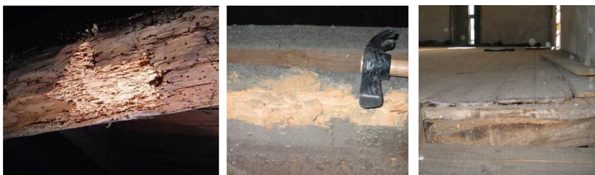
Fig. 2.11 - Presença de ataques de insectos xilófagos (lados esquerdo e centro) e deformação do pavimento devido a ataque de térmitas (lado direito).
