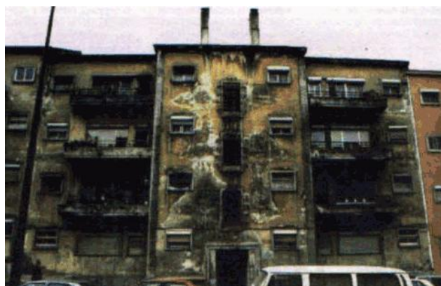
Fig.2.2 - Anomalias em fachadas e paredes exteriores
