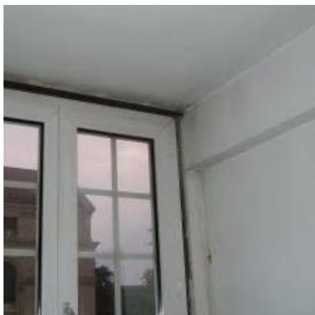
Fig.2.7 - Anomalias em paredes e caixilharia interior
