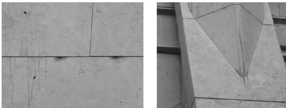
Fig. 2.10 - Ruptura de pedras nos pontos de inserção dos gatos e fissuras (lado esquerdo) e oxidação de peças metálicas (lado direito).
