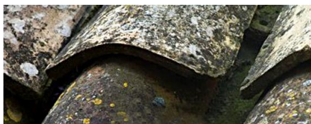
Fig.2.4 - Anomalias em cobertura inclinada
