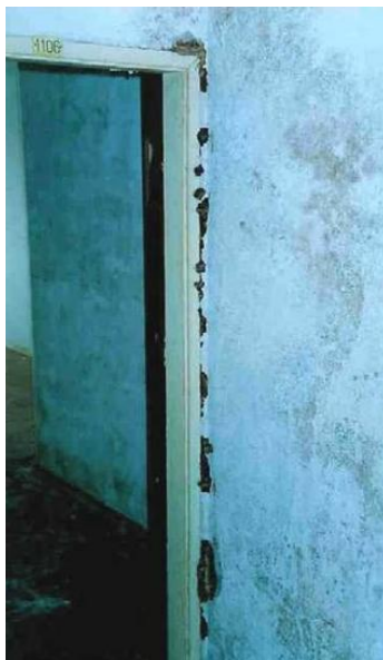
Fig.2.6 - Anomalias em pavimentos, paredes e caixilharia interior
