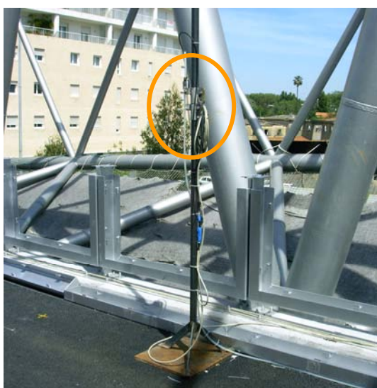
d) Sensor de pressão fixado numa torre metálica.
