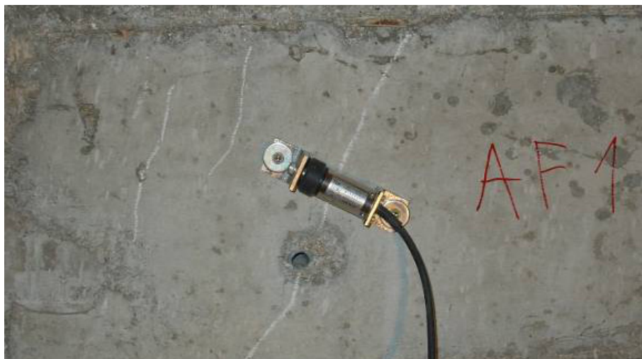
Figura 2.1 - Dispositivo instalado para monitorização expedita da abertura de fendas.
