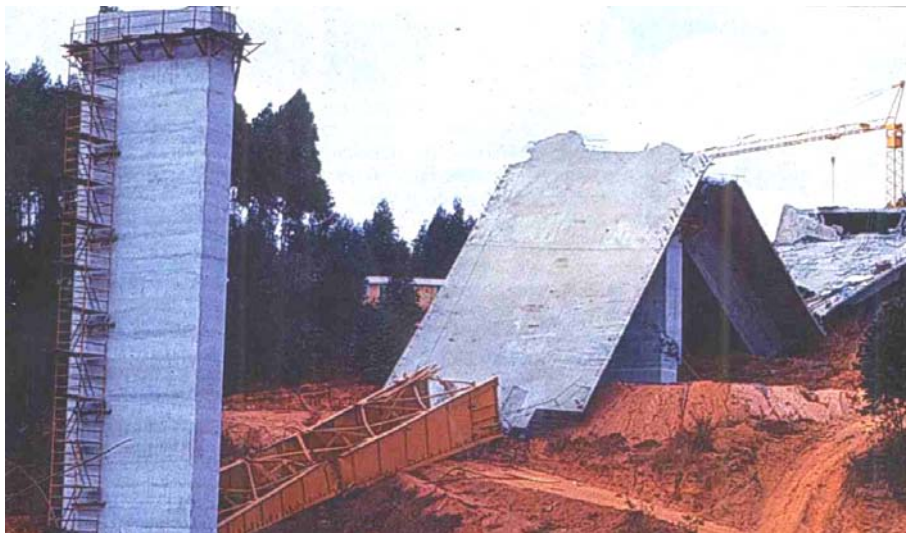
Figura 1.1 – Colapso da ponte Injaka, Africa do Sul, Julho de 1998.
