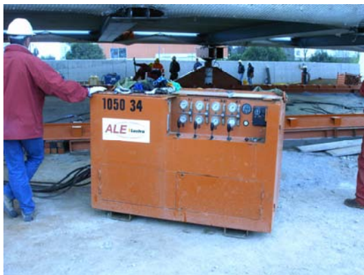
a) Sistema de controlo hidráulico.
