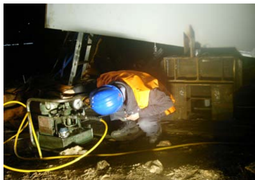
d) Central de pressão hidráulica.
