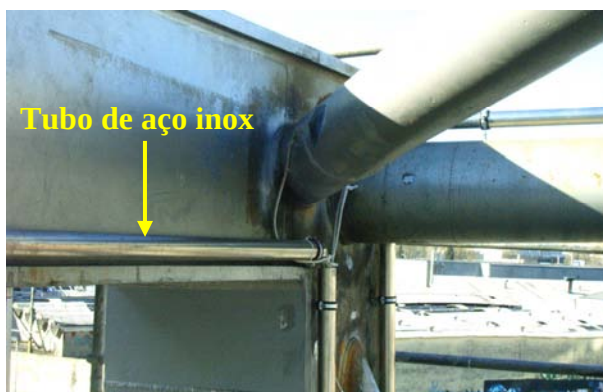
b) Condução dos cabos pelo interior de tubos de aço inox.
