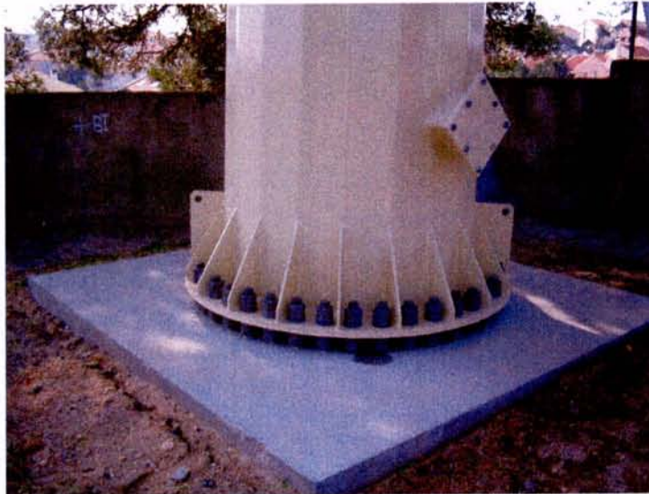
Figura 7 – Troço de base de um mastro assente sobre um conjunto de chumbadouros instalado na Caparica na Linha da Trafaria.
