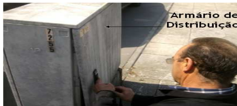
Figura 4.16: Armário de Distribuição.
