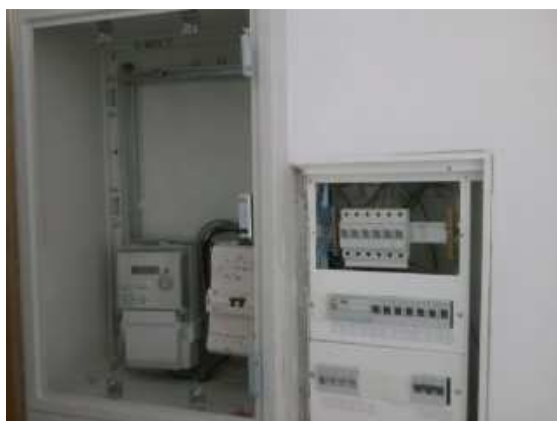
Figura 4.15: Instalação existente (BTN).
