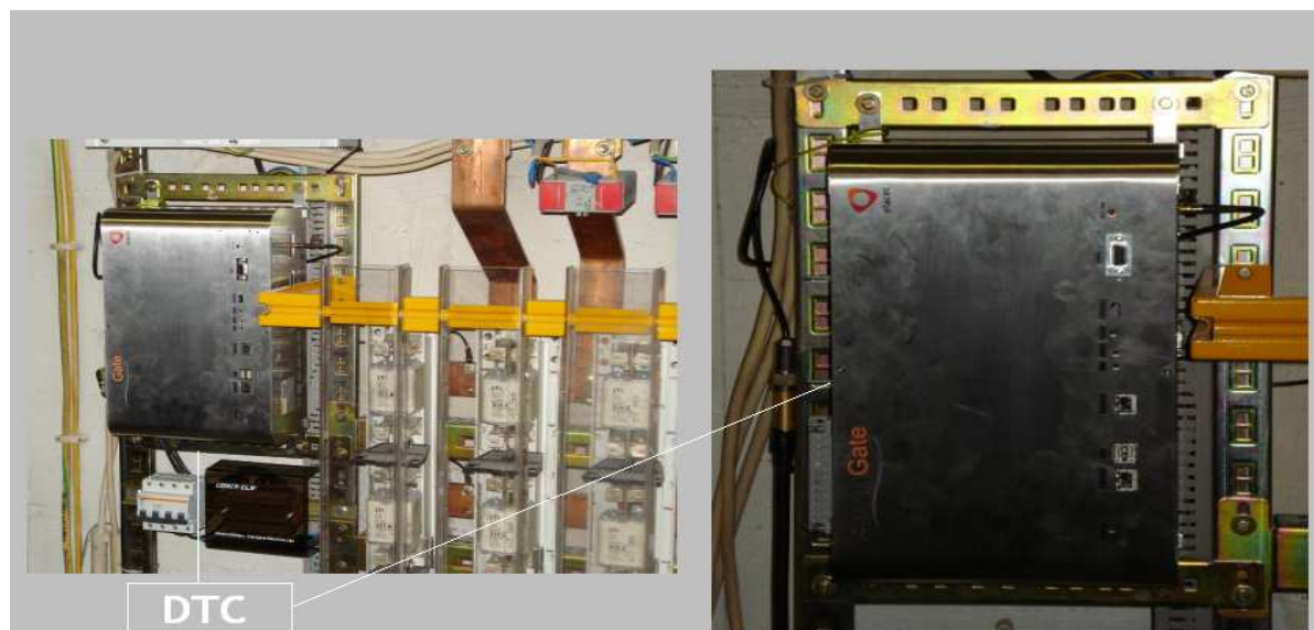
Figura 5.9: Aspecto da Instalação do DTC ( smart gate - EFACEC) [49].
