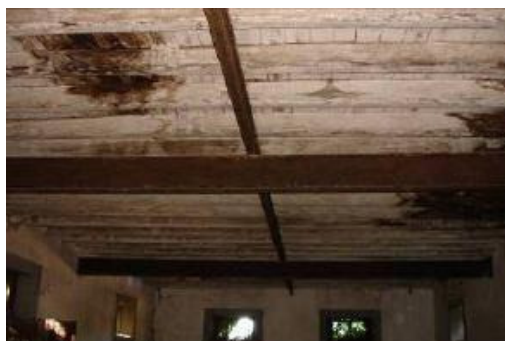
Fig. 5.42 – Divisão de vão existente através do uso de dois níveis de perfis metálicos (Dias;2008).
