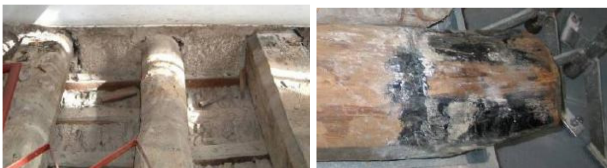
Fig. 2.3 – Apoio de vigas com topo alternado (à esquerda, Ilharco et al.;2006) e entregas com tratamento preservador (à direita, Costa et al.;2007).
