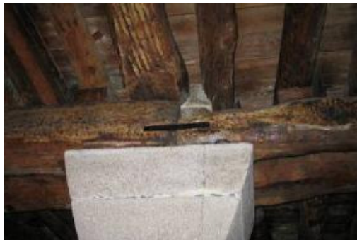
Fig. 5.26 – Reforço de ligação entre vigas em apoio comum, Casa do Infante, Porto (Dias;2008).
