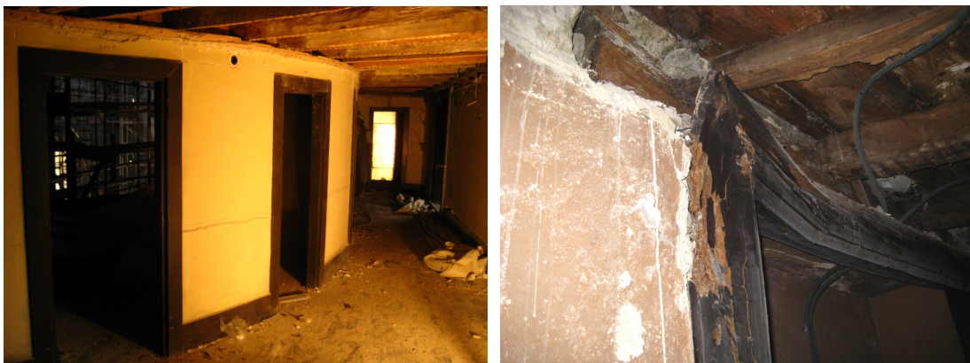
Fig. 6.18 – Zona de corredor de acesso aos camarotes com estrutura do pavimento superior visível (à esquerda) e padieira de porta degradada devido a deformações dos pavimentos (à direita).
