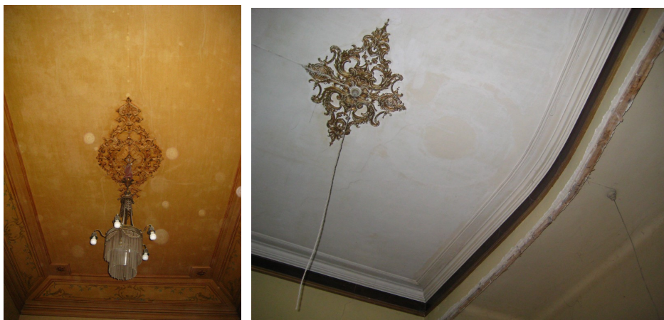
Fig. 6.8 – Tecto em estuque ornamental do hall de entrada (à esquerda) e à direita o tecto do buffet, no qual se verifica também o corte efectuado numa parede divisória em tabique.
