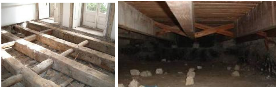
Fig. 2.1 – À esquerda, vigamento efectuado por troncos flaqueados (Ilharco et al.;2006) e à direita vigamentos em quina viva (Costa et al.;2007).
