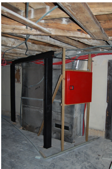
Fig. 6.21 – Colocação de escoramento para apoio dos elementos estruturais dos pavimentos devido a colocação de condutas do sistema AVAC.
