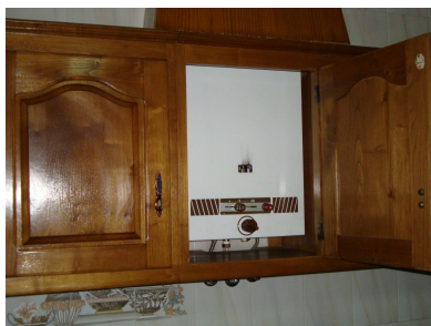
Fig.4.45. – Sistema de aquecimento das águas quentes sanitárias da habitação 1
