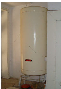
Fig.4.47. – Sistema de aquecimento das águas quentes sanitárias da habitação 3
