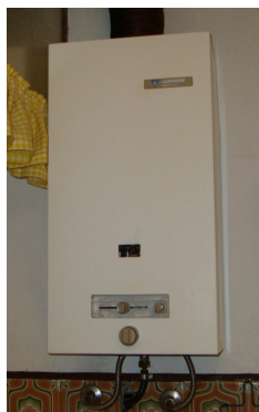
Fig.4.46. – Sistema de aquecimento das águas quentes sanitárias da habitação 2
