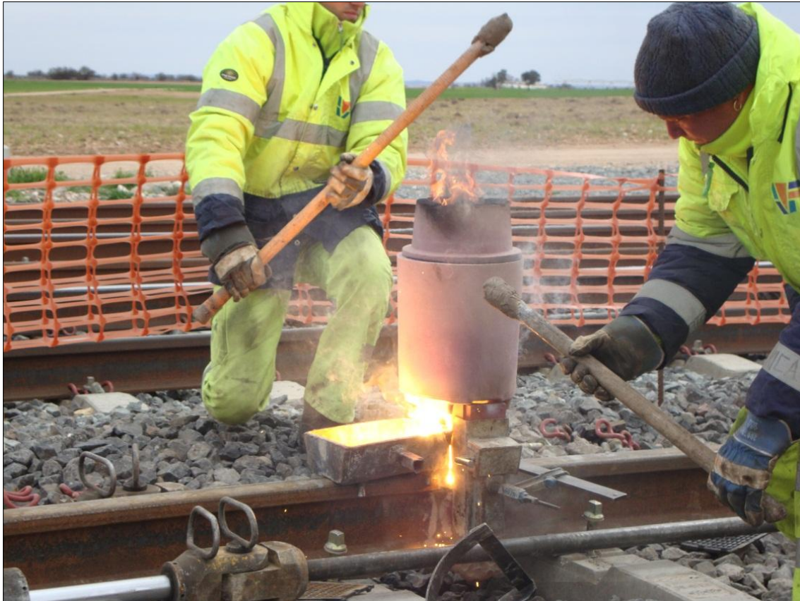
Fig. 3.30 – Escorrimento do líquido proveniente da reacção química
