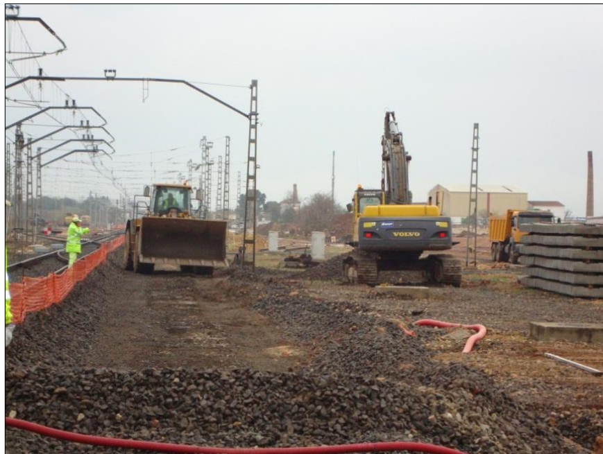
Fig. 3.4 – Balastro parcialmente removido
